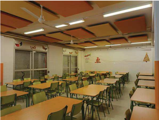
Menjador amb ventiladors instal·lats
