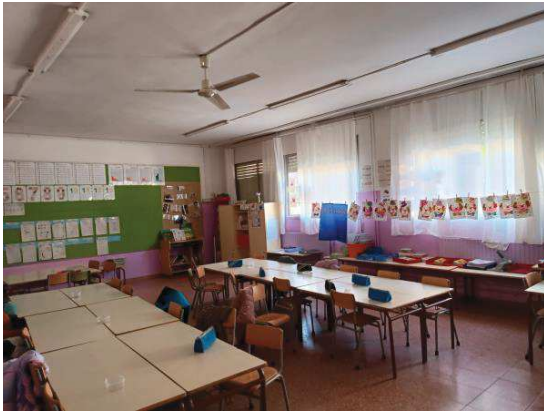
Ventilador instal·lat (afegir-ne un) - aula
