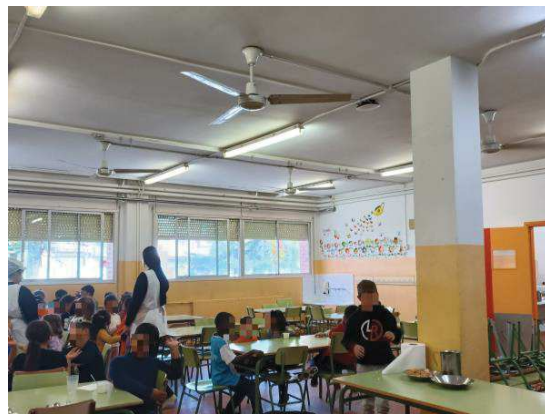
Menjador – ventiladors a substituir
