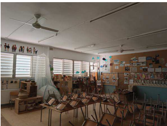
Ventiladors instal·lats – Aules d'infantil
