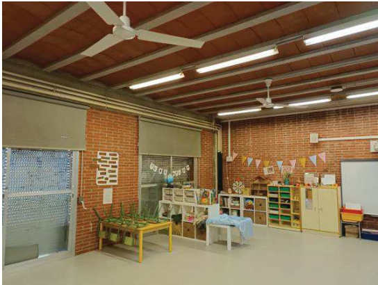
Aula tipus amb ventiladors instal·lats
