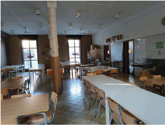
Ventiladors instal·lats - menjador
