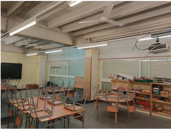
Aula amb ventiladors instal·lats
