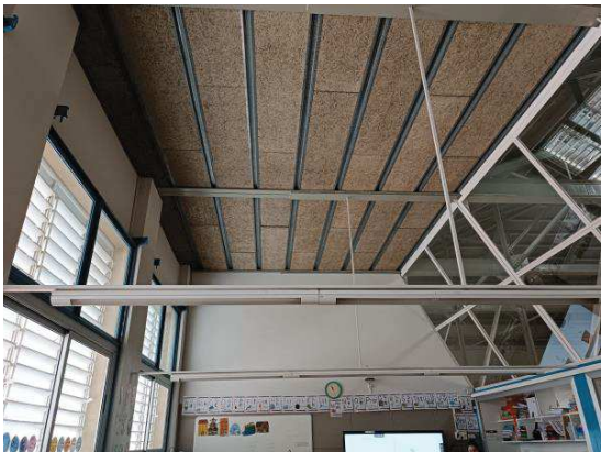
Fals sostre i estructura aules primària (planta segona)
