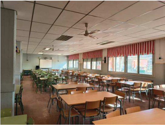
Ventiladors instal·lats - menjador
