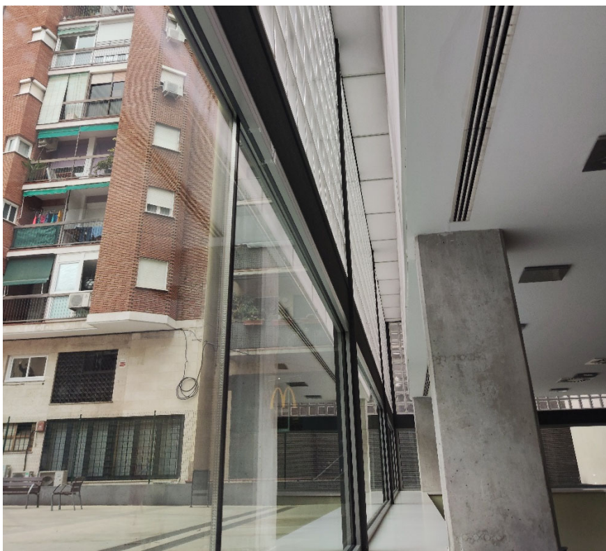
Tancament de façana vist de de l'interior. Reixeta perimetral d'impulsió.
