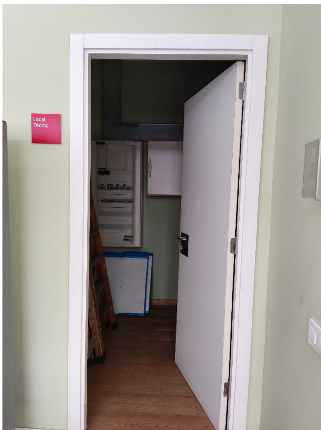
Entrada a sala de quadre elèctric
