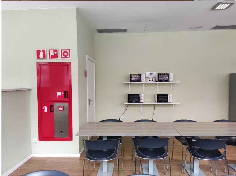
Entrada a sala d'instal·lacions/magatzem. BIES
