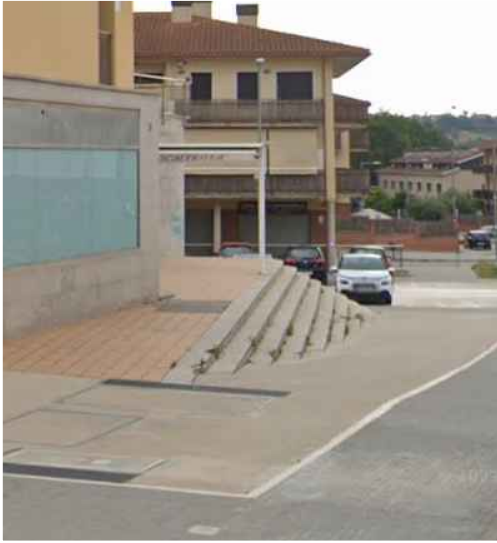
FOTO 8. esglaons en mal estat
