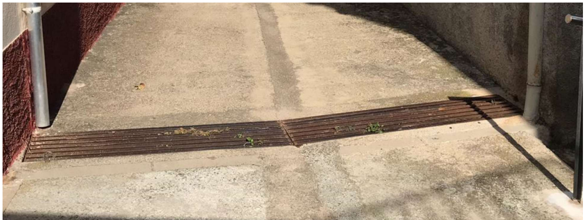
Reixa actual en mal estat de conservació.
