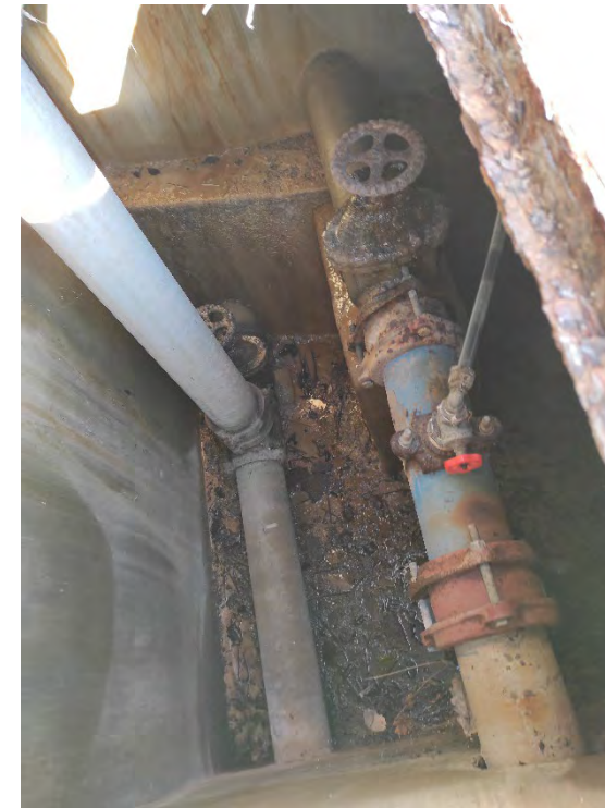
Fotografia 3. Canonades i valvuleria del dipòsit existent de Solivent
