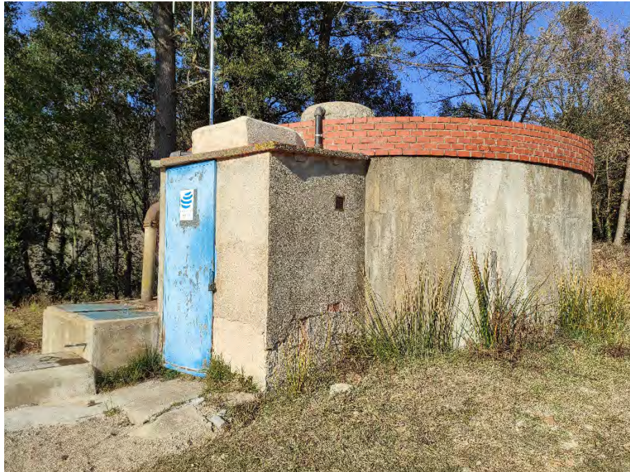
Fotografia 1. Dipòsit existent de Solivent
