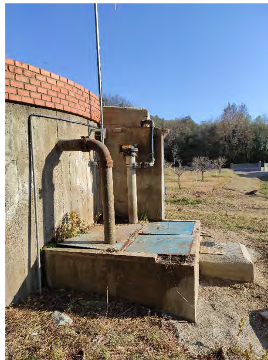
Fotografia 2. Dipòsit existent de Solivent
