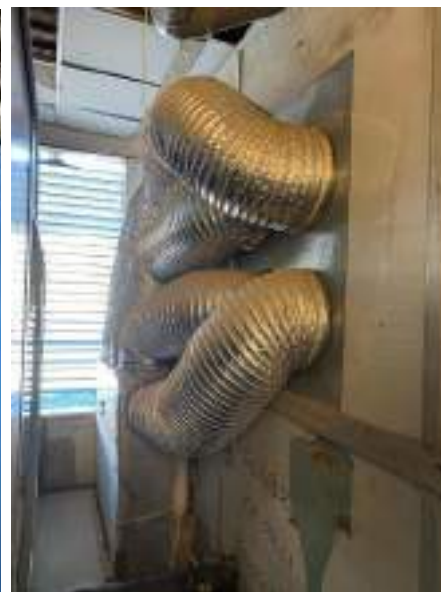
Fotografia 26. Unitat de tractament d'aire consistent en fancoil model FO492 marca AIRLAN, ubicat en planta sotacoberta que dona servei als diversos espais de la sala gran de la biblioteca. Es substituirà.
