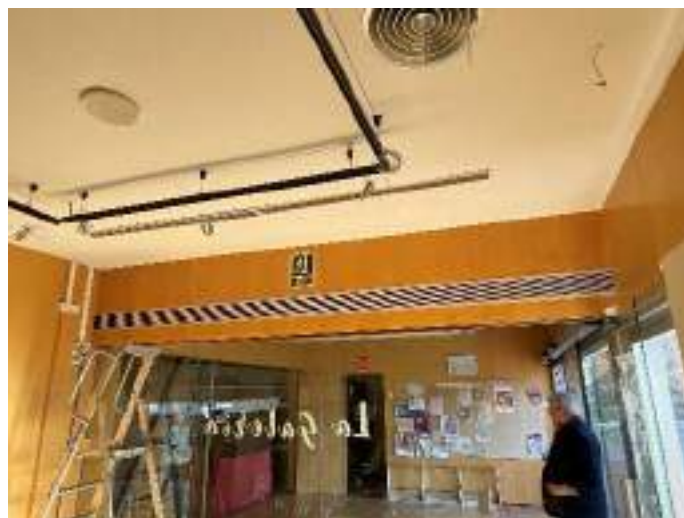
Fotografia 12. Detall reixa de retorn per plenum interior sala polivalent – Clara Simó.
