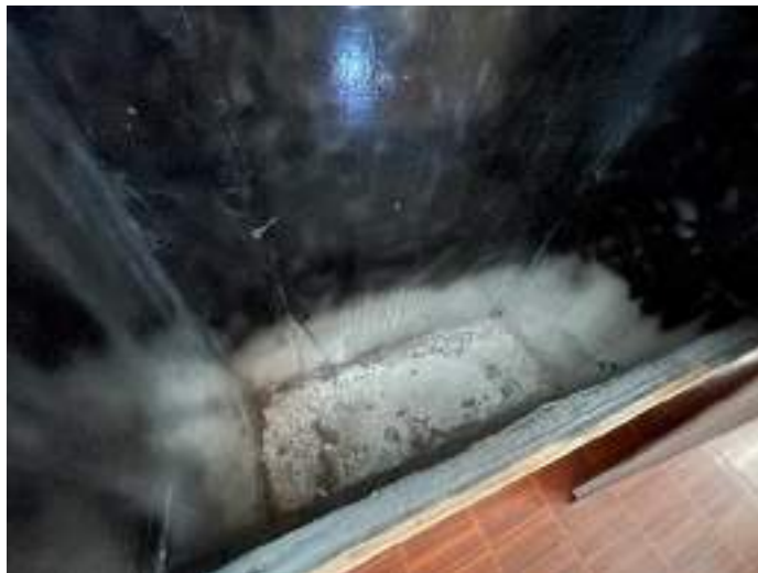
Fotografia 09. Detall 2 de l'interior del retorn per plenum de la zona biblioteca.
