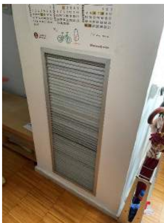
Fotografia 05. Reixa retorn de la zona de treball intern i despatx.
