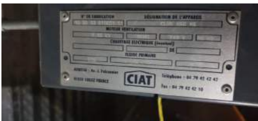
Fotografia 14. Detall fancoil model CLUB H60 H6 1,65 KV, marca CIAT ubicat al sostre del bany de la planta baixa i que dona servei a la sala polivalent. Es substituirà.
