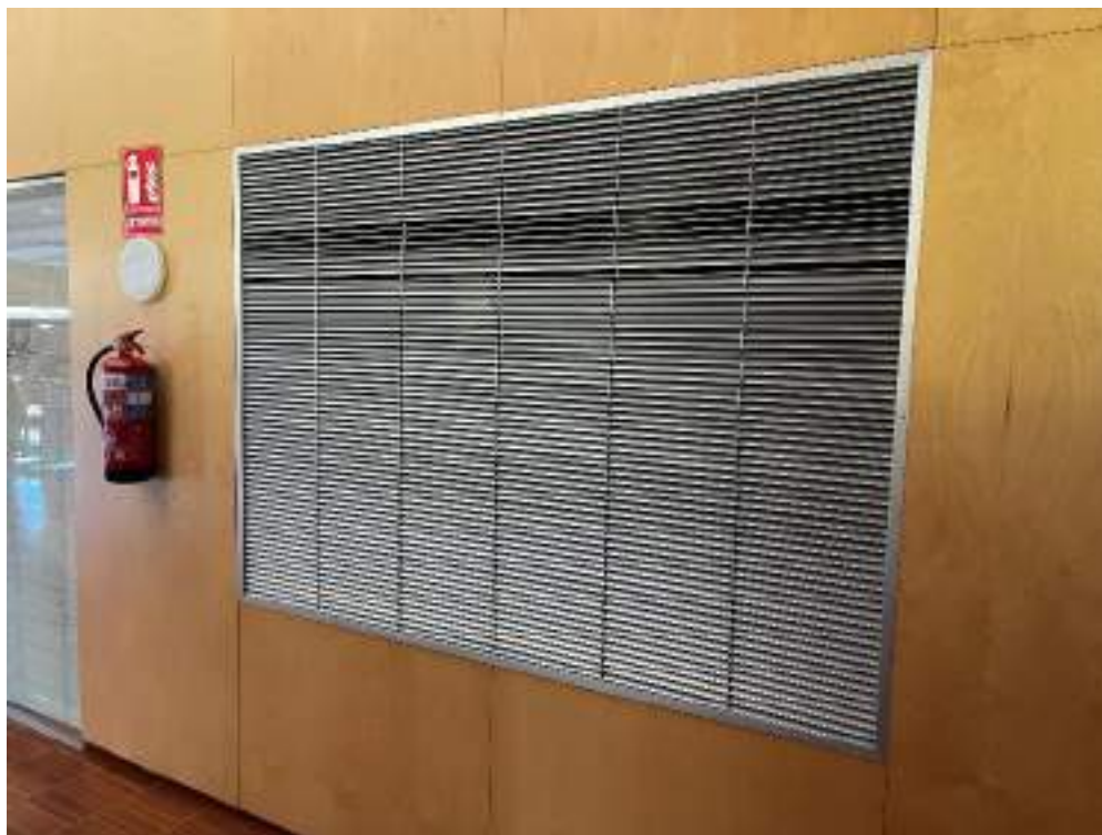
Fotografia 07. Reixa retorn per plenum zona biblioteca.
