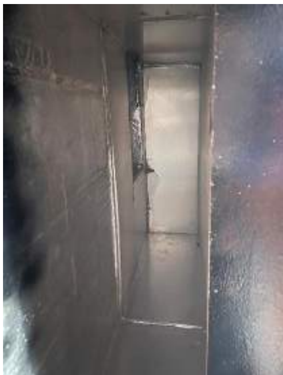
Fotografia 10. Detall 3 de l'interior del retorn per plenum de la zona biblioteca.
