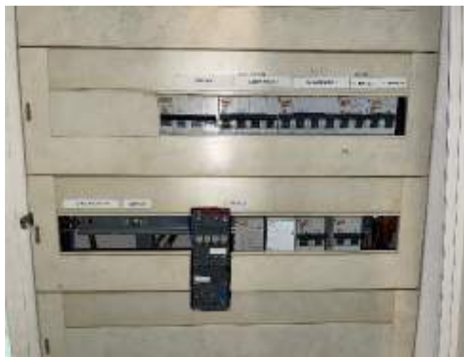
Fotografia 23. Quadre elèctric de la instal·lació de climatització.
