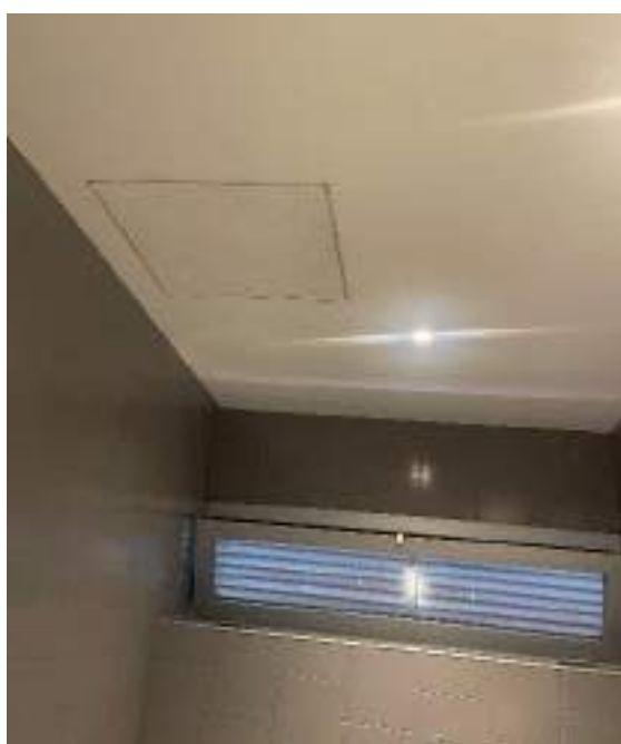
Fotografia 15. Fals sostre bany planta baixa on s'ubica fancoil que dona servei a la sala polivalent – Clara Simó.
