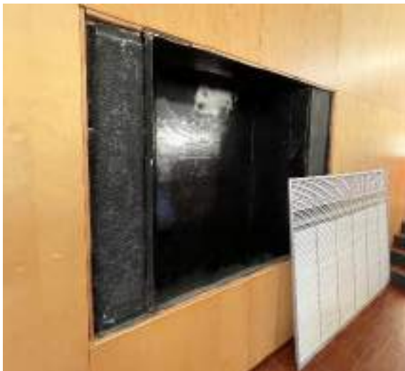
Fotografia 08. Detall 1 de l'interior del retorn per plenum de la zona biblioteca.
