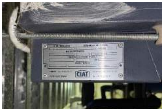
Fotografia 17. Detall fancoil model CLUB H40 H6 1,1 KV, marca CIAT ubicat al sostre de la planta pis de la sala d'instal·lacions i que dona servei al despatx i zona de treball intern. Es substituirà.
