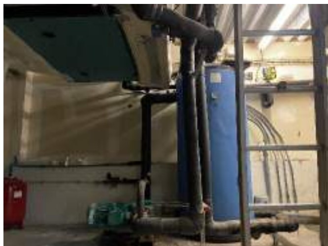
Fotografia 22. Detall dipòsit, vas d'expansió i motor de la instal·lació hidràulica. Fancoil ubicat en fals sostre que dona servei a la zona de treball intern.
