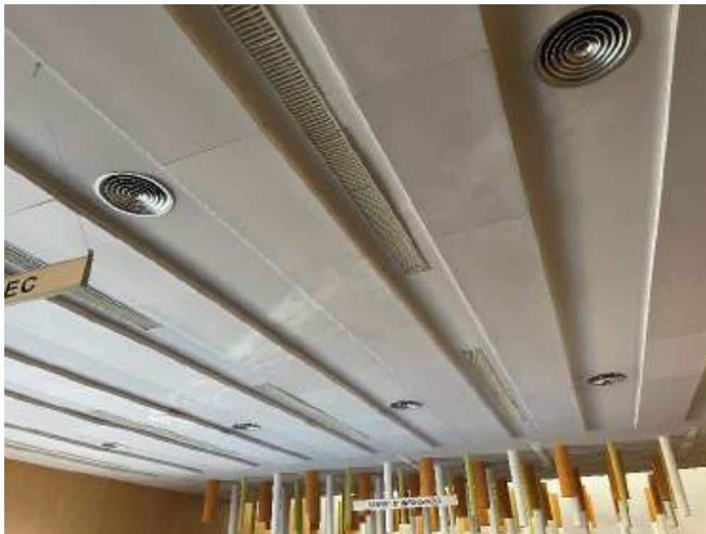
Fotografia 06. Detall de les reixes d'impulsió de la sala gran de la biblioteca.
