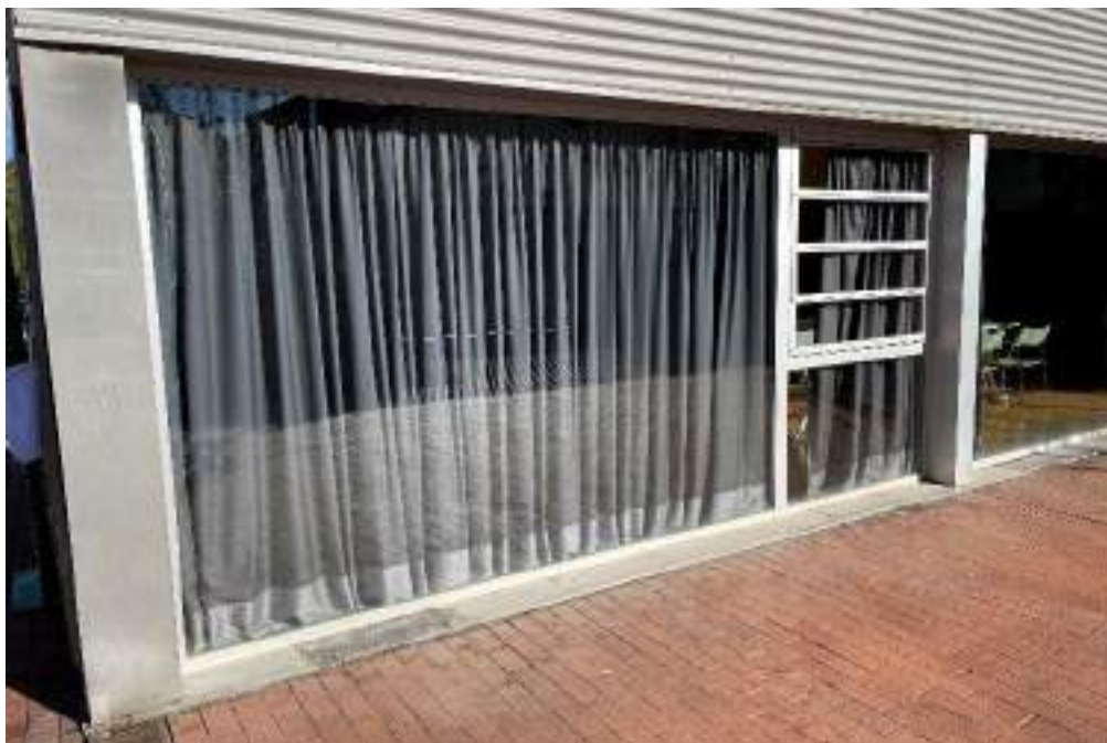
Fotografia 03. Detall obertura sala polivalent – Clara Simó. El vidre esdevé un focus d'entrada de calor. S'aplicarà un tractament de làmina solar per resoldre-ho.
