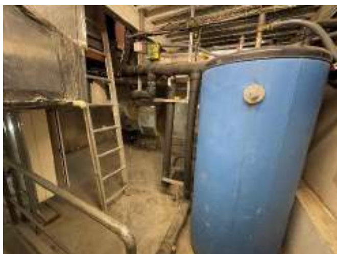
Fotografia 20. Detall sala d'instal·lacions planta pis. Accés a planta sotacoberta mitjançant escala de mà. També es mostra part de la instal·lació hidràulica.
