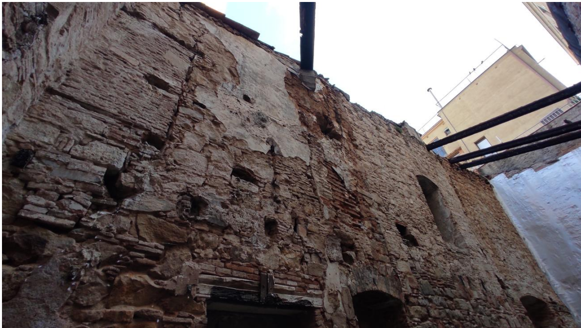
Figura 3. Disfuncions detectades en l'interior de l'edificació.
