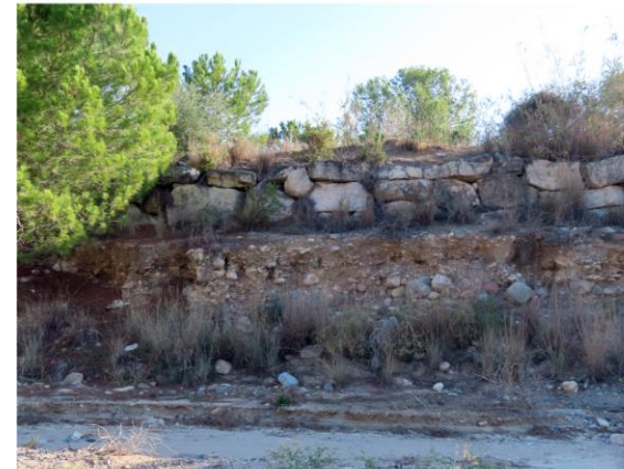
3. Línia d'escullera la marge esquerre de l'antiga llera, ara incidida notablement, de manera que ha quedat com una estructura obsoleta.
