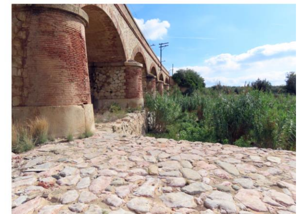
6. Les proteccions fetes al Pont de la Via per evitar el desfalcament dels pilars han generat una trampa de sediments i un salt a la llera d'uns 3 m.
