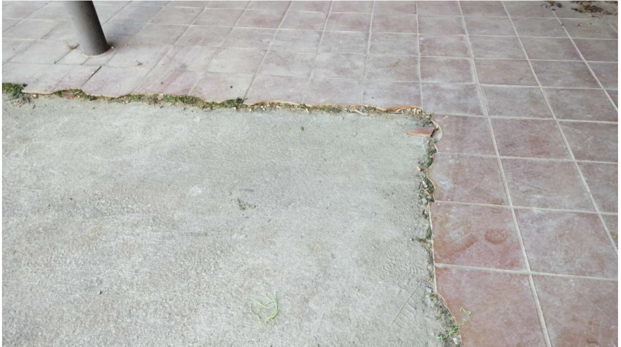
Paviment a reparar a planta baixa
