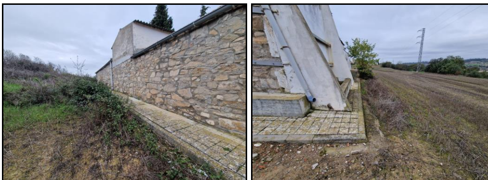
Fotografia 1, 2, 3 i 4. Vista del mur perimetral més afectat i els contraforts existents.
