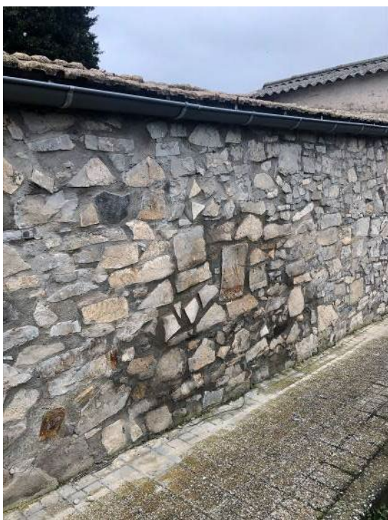
Vista mur amb filtracions de la coberta
