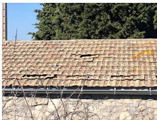
Detall coberta on s'observa moviment de teules.
