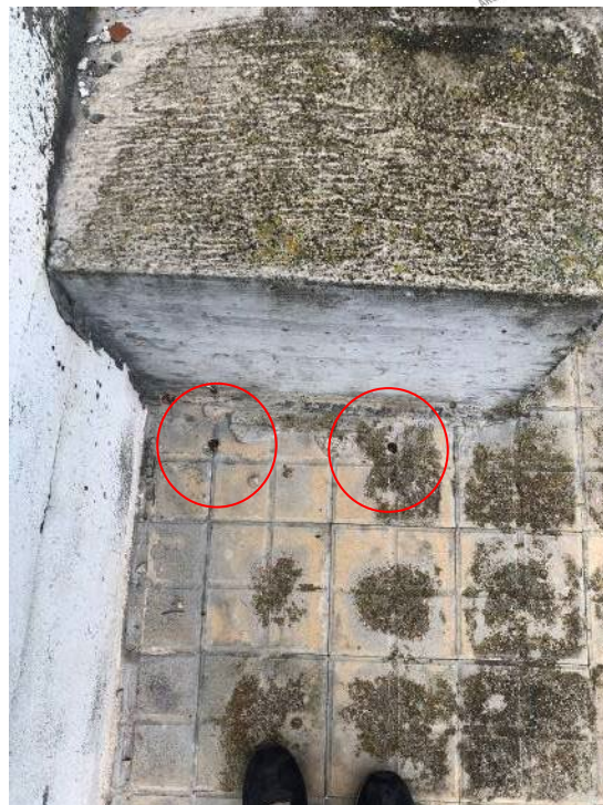
Vista forat possibles injeccions de resines.
