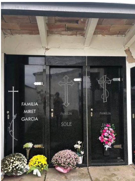
Vista fissures en frontals de nínxols.
