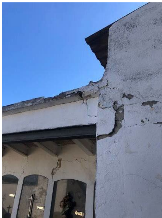
Vista fissures en arrebossats.
