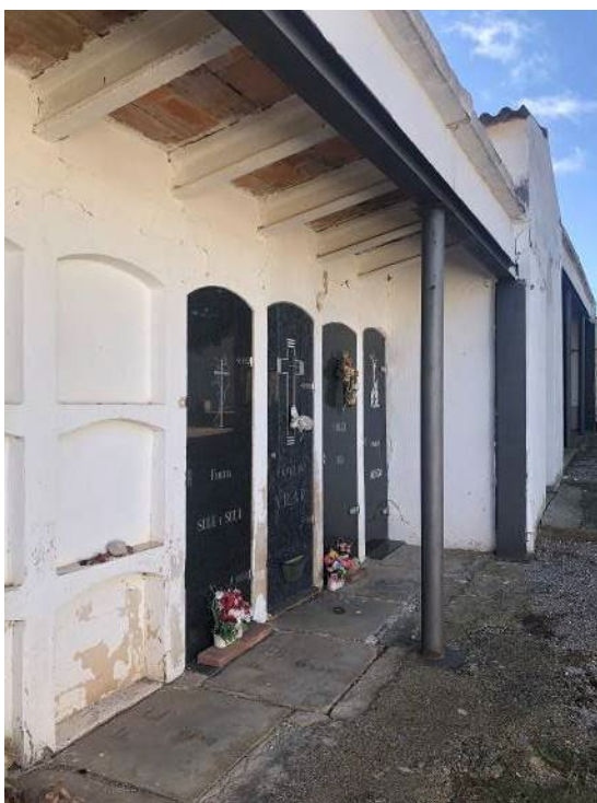
Vista fissures en frontals de nínxols.
