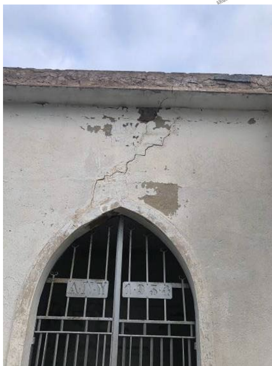
Vista fissures en arrebossats.
