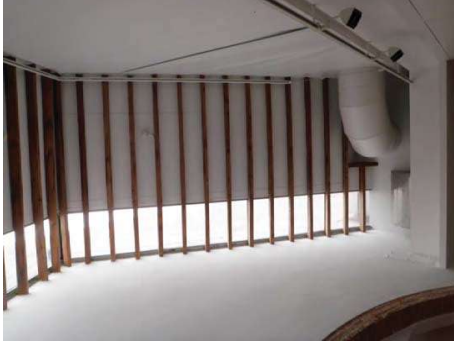
Imatge 2. Pas d'instal·lacions, Vista interior
