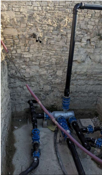
Il·lustració 6: Canalitzacions del col·lector
