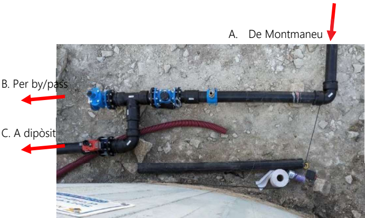
Il·lustració 12: Connexió al dipòsit de la Panadella (abans de formar l'arqueta)
