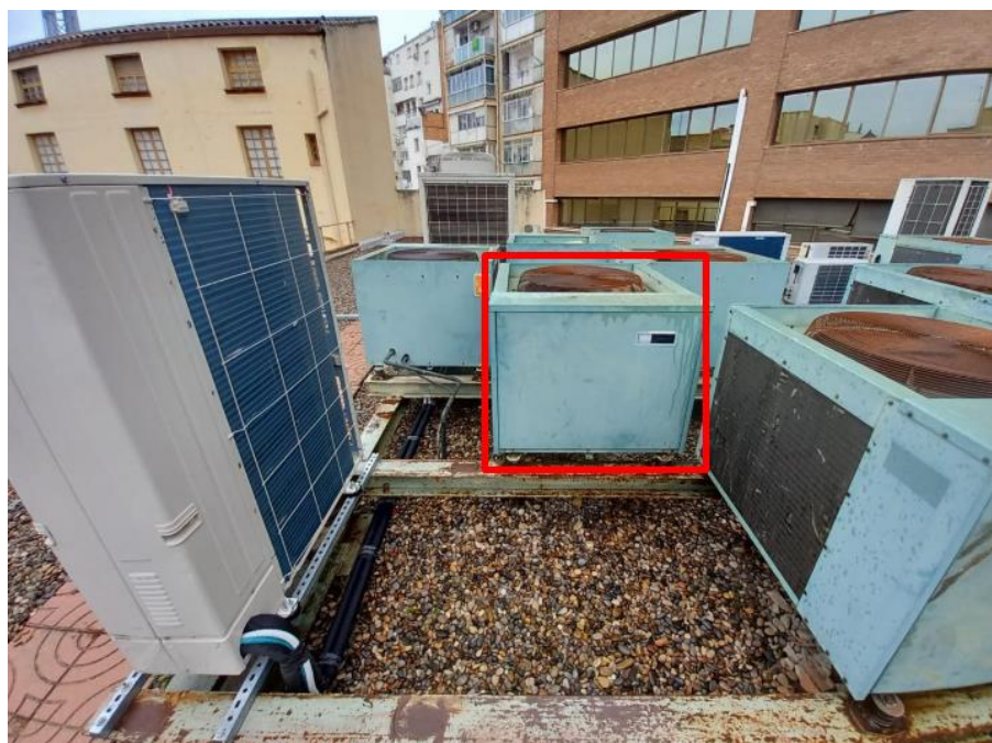
Imatge 16: Equip Exterior Climatització Auditori i Vestíbul (a retirar)
