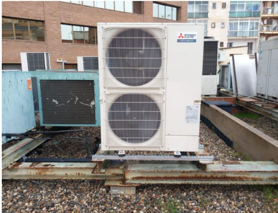
Imatge 17: Equip Exterior Climatització Auditori i Vestíbul (a mantenir)
