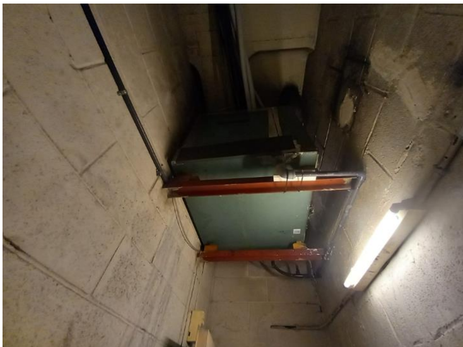
Imatge 11: Equip Interior Climatització Auditori i Vestíbul (a retirar)
