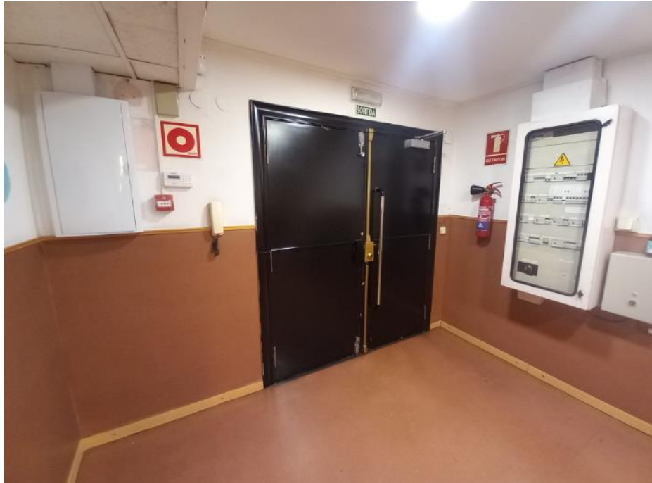
Imatge 13: Quadres elèctrics Entresol
