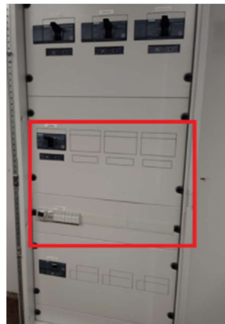
Figura 8 Punt de connexió a QGD
