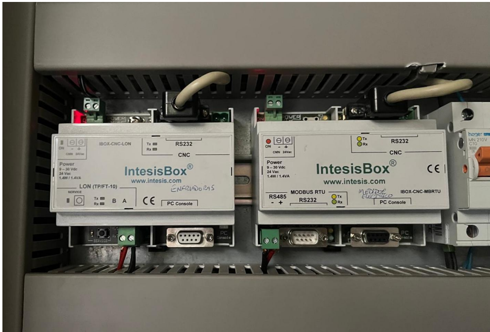
IntesisBox - Integració comptadors Modbus - Integració refredadores LON.
