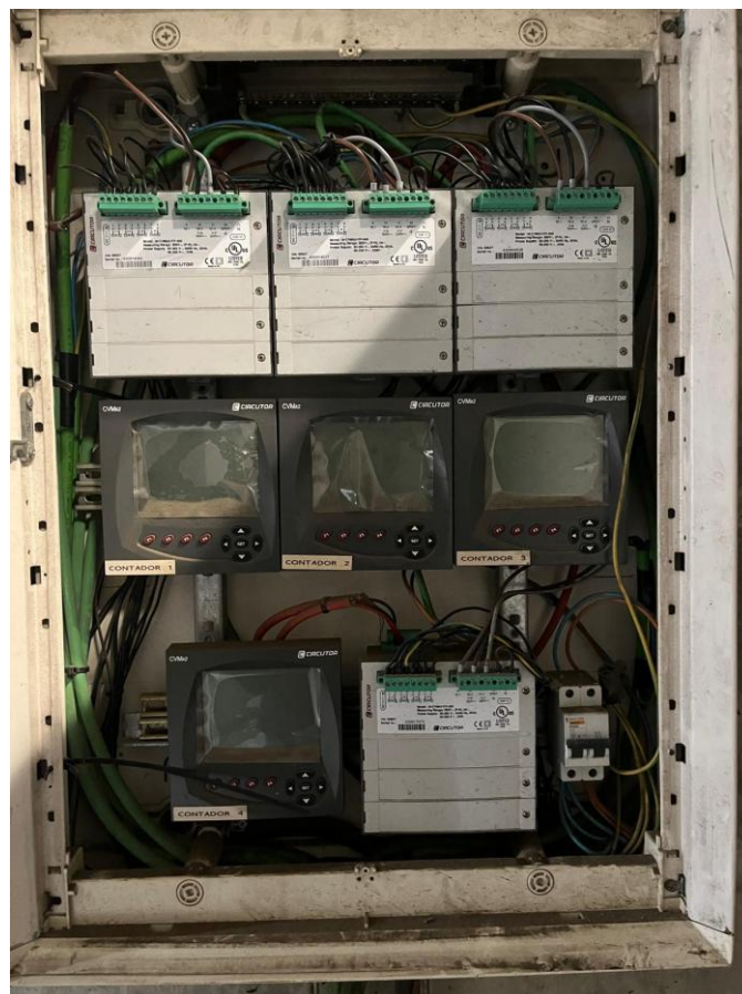
Comptadors elèctrics de refredadores.
