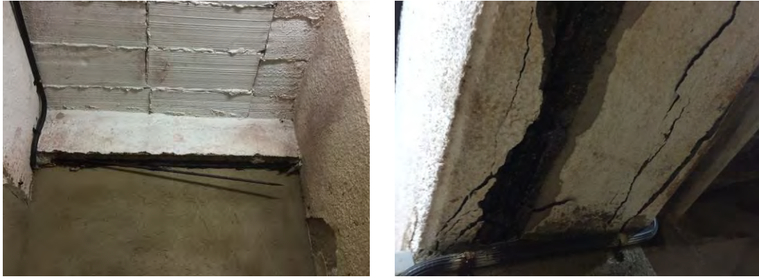
Imatge 7-48. Severa degradació de material en bigueta prefabricada en sostre de planta soterrani (II)
