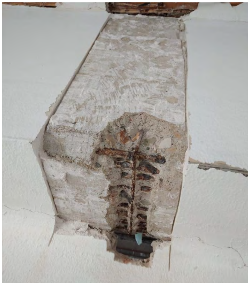
Imatge 7-44. Corrosió d'armadures en jàsseres de formigó armat
