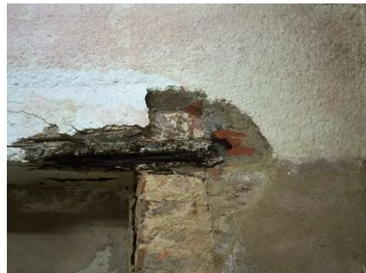
Imatge 7-47. Severa degradació de material en bigueta prefabricada en sostre de planta soterrani
