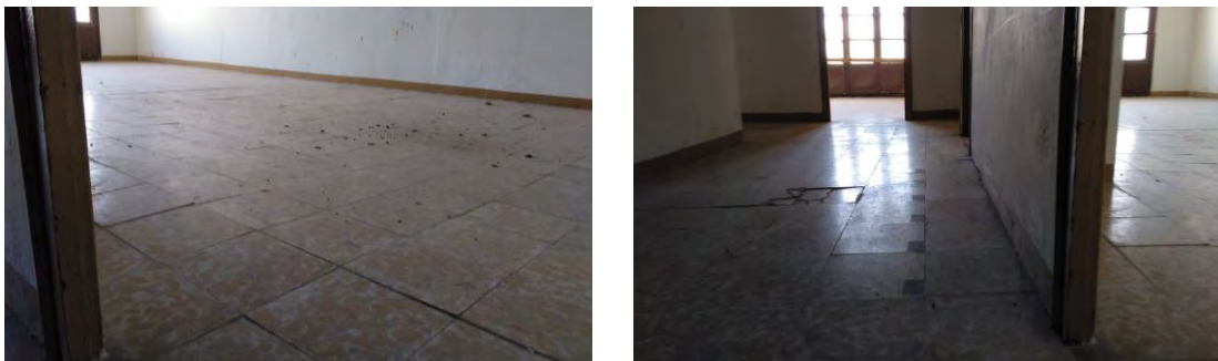
Imatge 7-55. Lesions en paviments de planta segona
