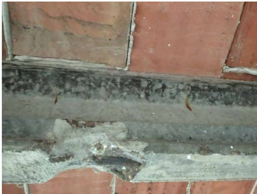
Imatge 7-43. Corrosió d'armadures en biguetes prefabricades
