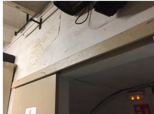
Imatge 7-17. Volta recolzada en jàssera biguetes de fusta en sostre de planta soterrani
