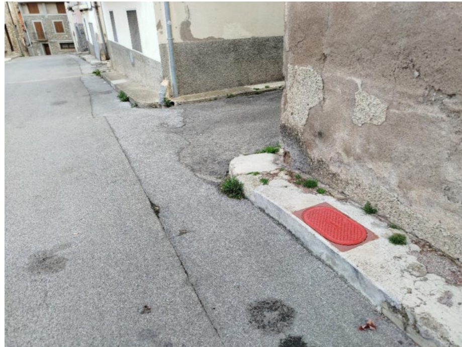
Figura 24: Detall hidrant C/ de la Pujada de Sant Antoni
