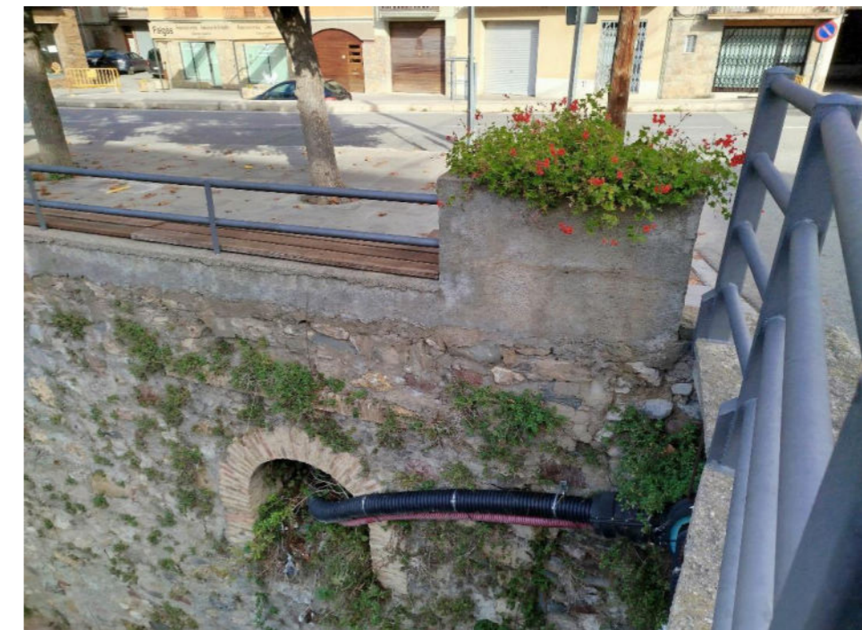
Figura 11: Detall pas canonades per sota la carretera de Ripoll
