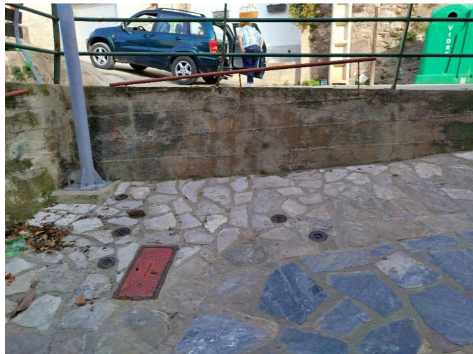
Figura 20: Detall hidrant i trampillons a la Pl. de Sant Isidre
