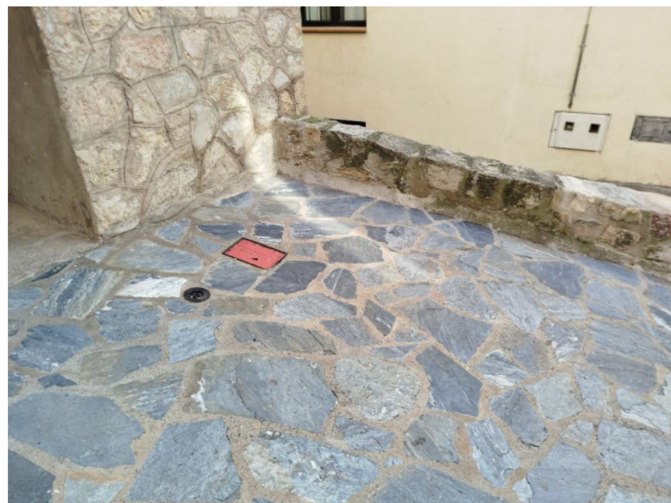
Figura 21: Detall hidrant C/ de la Unió
