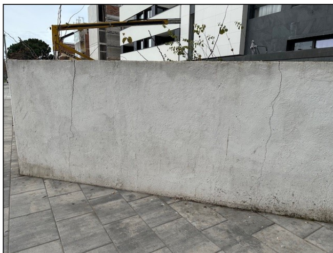
Fotografia 1. Vista de l'estat del mur
