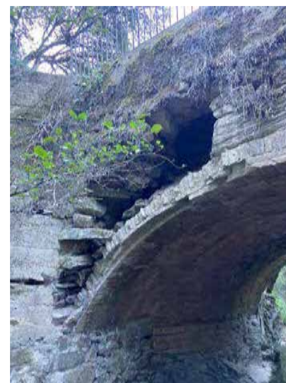
Fotografia 4. Desperfecte principal a reparar
