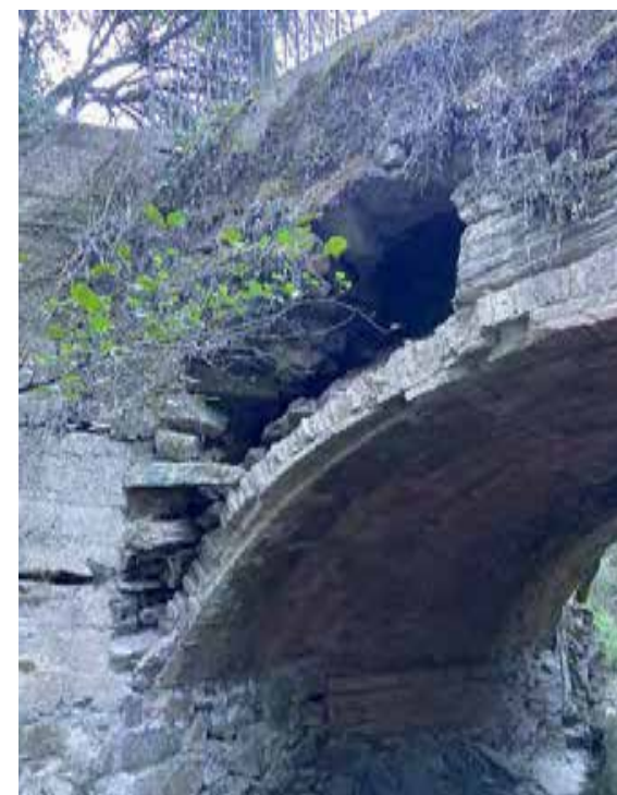
Imatge 1. Fotografia del desperfecte principal.
