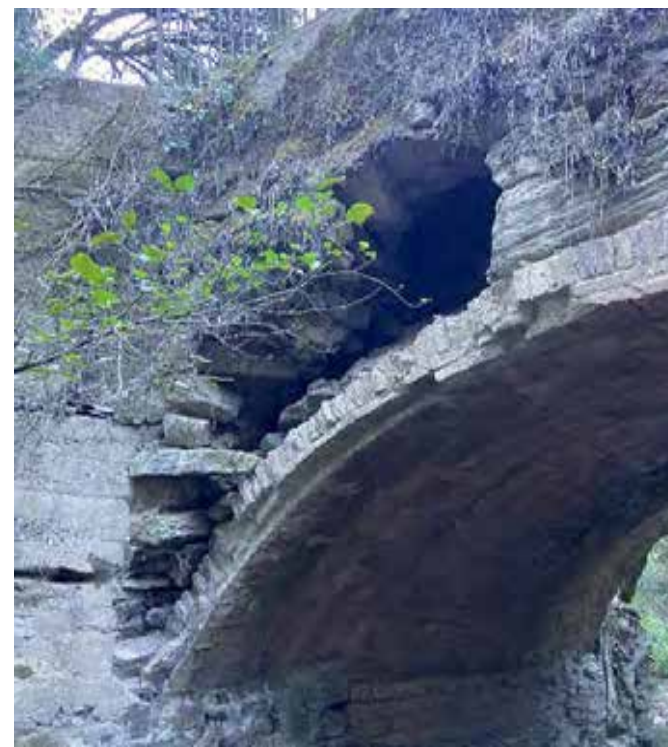
Imatge 1. Fotografia del desperfecte principal.
