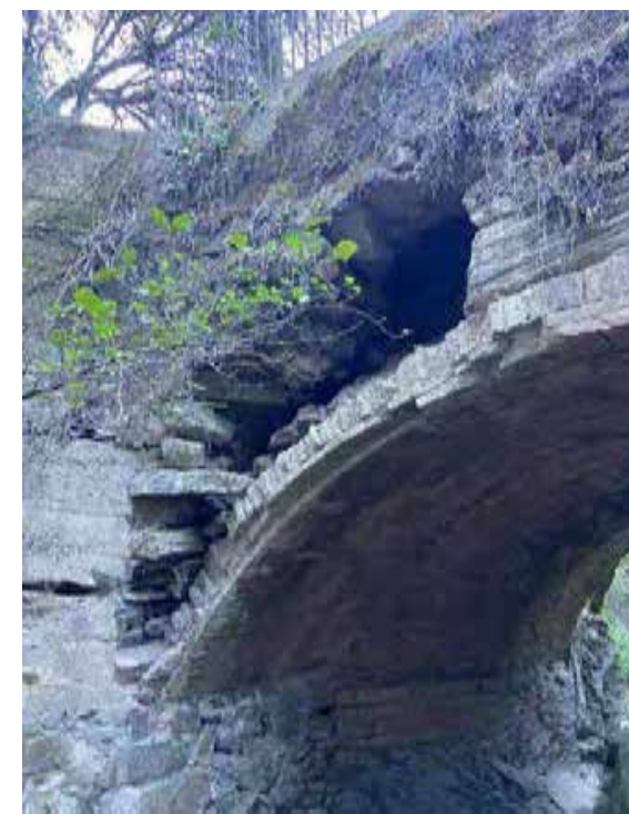
Imatge 1. Fotografia del desperfecte principal.
