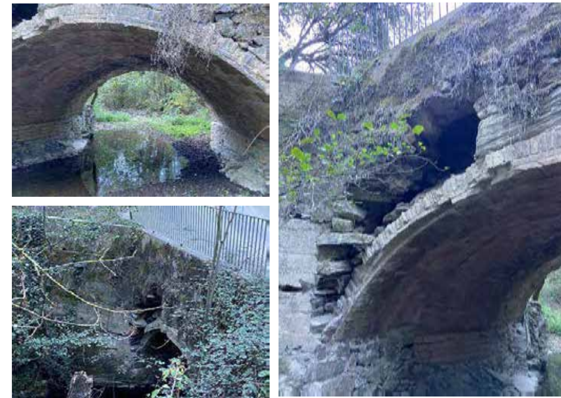
Figura 7. Fotografies de l'estat actual del Pont de la Bisbal des d'aigua amunt, observant-s'hi els importants desperfectes.
