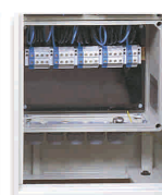
Espacio para conexiones
