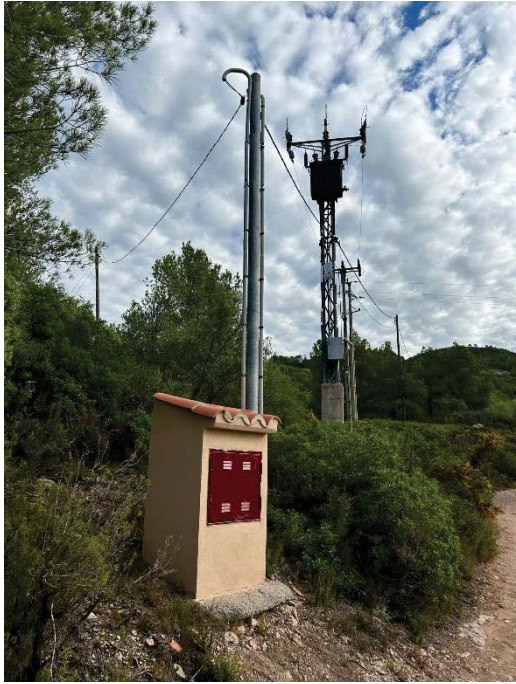
Fotografia 56. Caseta comptador i transformador
