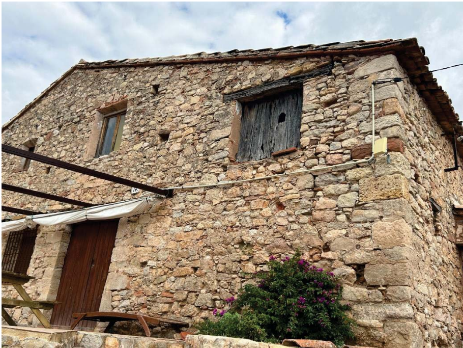
Fotografia 60. Detall entrada línia elèctrica a la masia
