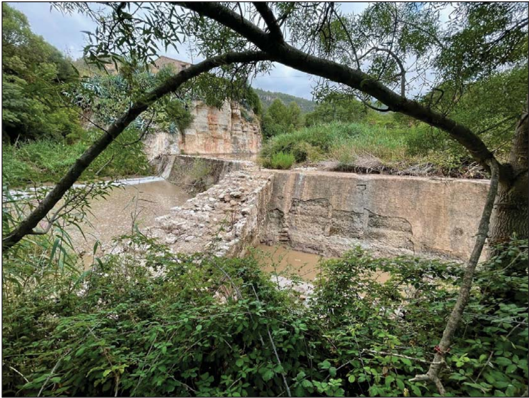
Figura 9. Fotografia de la presa, juliol 2022. A la imatge es pot observar la colmatació del mur esquerra per sediments fins, colonitzats per vegetació helòfita després de la crescuda de 2015
