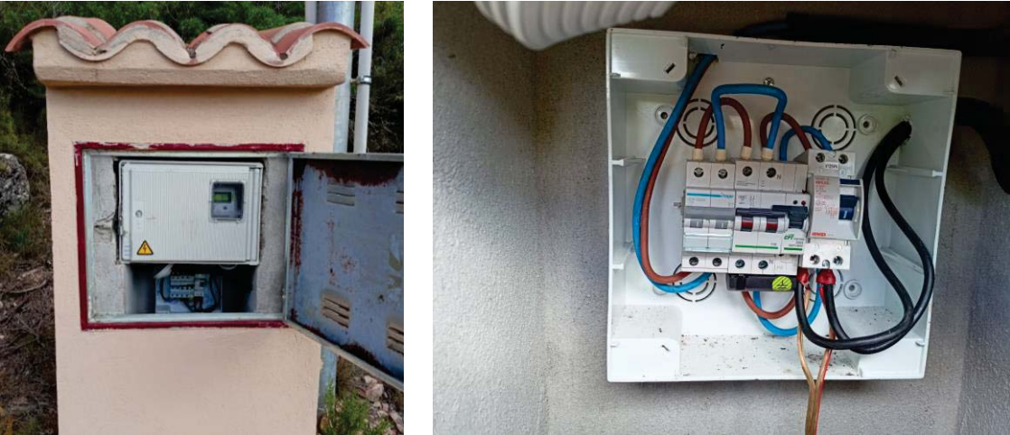
Figura 4_Comptador ubicat a l'entrada del camí d'accés des de la carretera C-37
