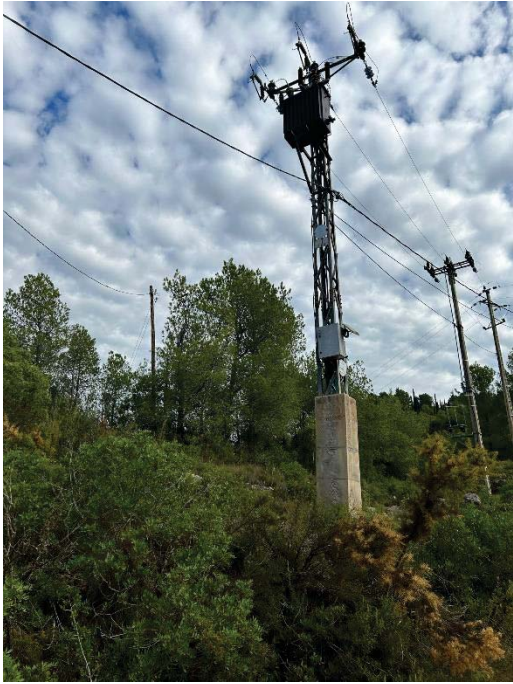
Fotografia 55. Transformador línia elèctrica
