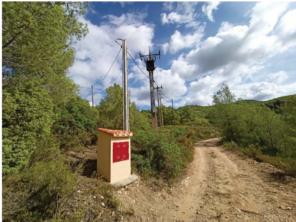
Figura 1_Armari comptador i transformador
