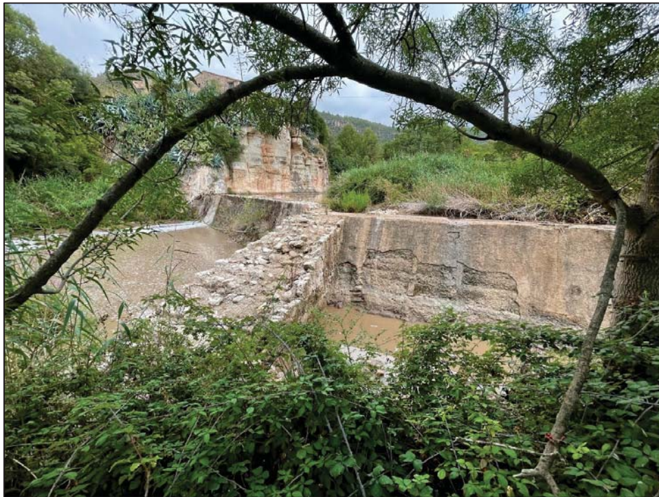
Figura 3. Fotografia de la presa, juliol 2022. A la imatge es pot observar la colmatació del mur esquerra per sediments fins, colonitzats per vegetació helòfita després de la crescuda de 2015
