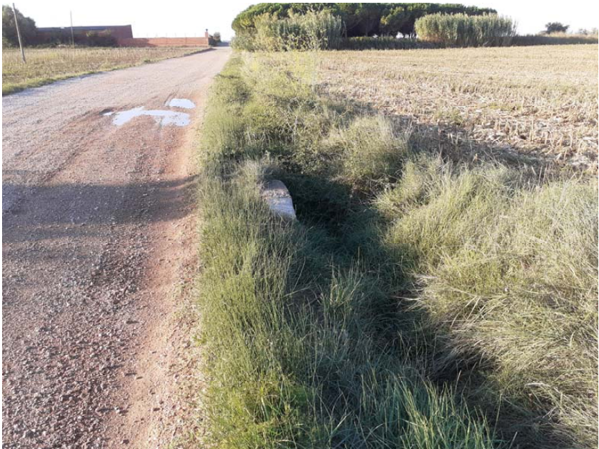
Cuneta i pas d'aigües de pluja al punt 0+192,5. Una mica més enllà, aigua embassada.
