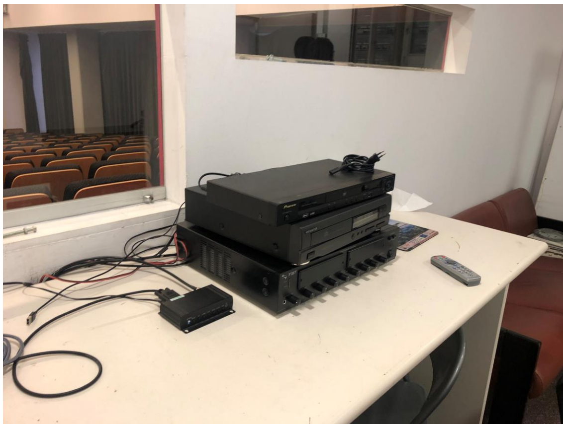
Figura 4. Sala de control i equips existents.
