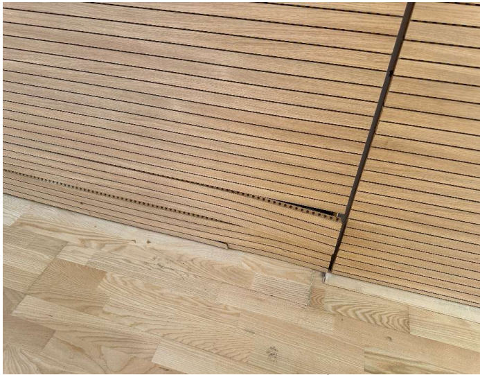
IMATGE TRENCAMENT PUNTUAL EN REVESTIMENT ACÚSTIC
