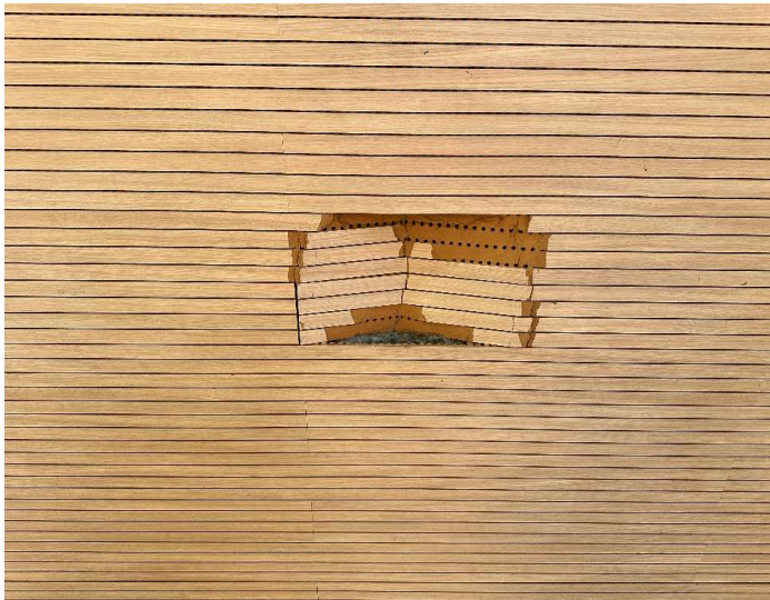
IMATGE TRENCAMENT PUNTUAL EN REVESTIMENT ACÚSTIC
