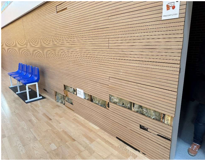
TRENCAMENTS EN REVESTIMENT DE PANELLS ACÚSTICS.
