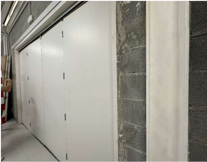
IMATGE PORTES DE FUSTA DE 4 FULLES A REEMPLAÇAR.
