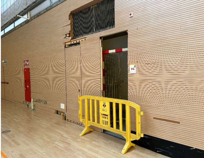
ESTAT ACTUAL. OBERTURA RESULTANT DESPRÉS DE TRENCAMENT I RETIR DE PORTA DE FUSTA. TRENCAMENTS EN REVESTIMENT DE PANELLS ACÚSTICS
