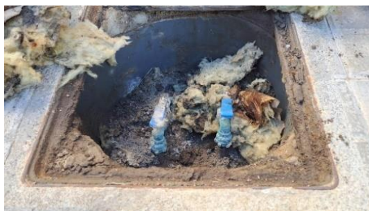
Il·lustració 5. Escomesa habitatges C/Raier nº23
