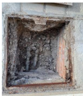
Il·lustració 4. Escomesa habitatges Av/Catalunya nº18
