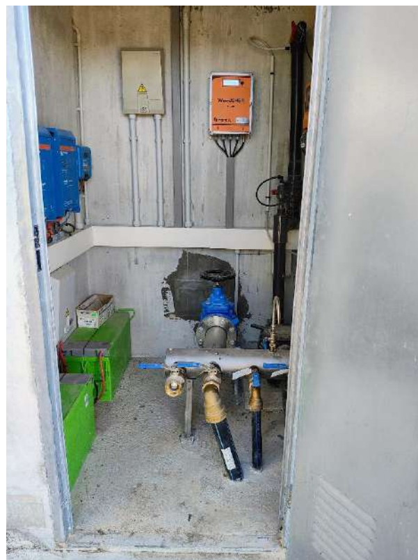
Figura 9. Dipòsit Granges - caseta de vàlvules
