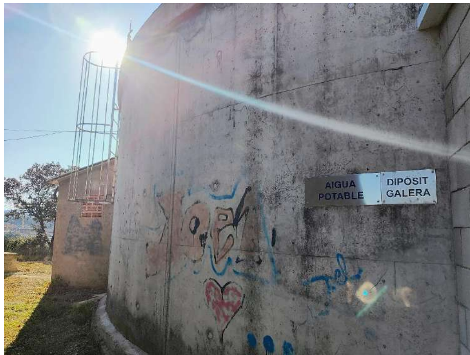
Figura 1. Dipòsit Galera - Exterior caseta de bombes est
