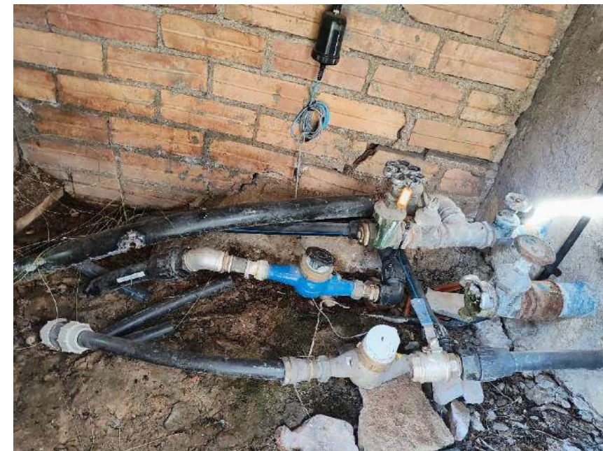
Figura 11. Dipòsit Galera - vàlvules de control per a subministrament a zona de granges.
