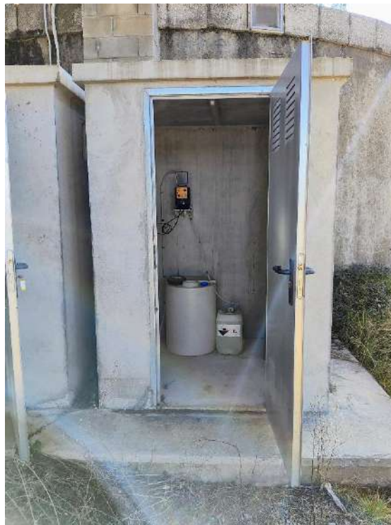
Figura 4. Dipòsit Galera - zona d'emmagatzematge de químics per a cloració
