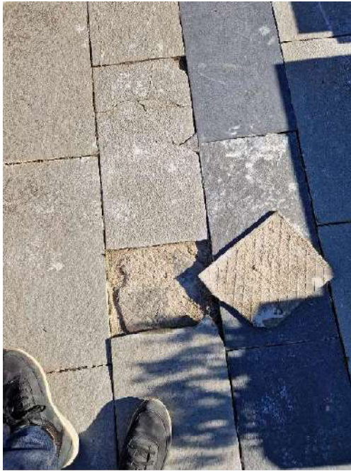
Imatge 4. Algunes lloses han quedat completament desencolades del terra. En aquest cas es pot apreciar la irregularitat del paviment inferior.
