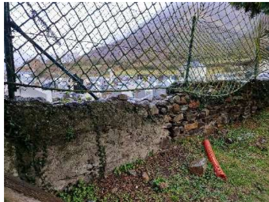
Imatge 9. El mur sud, construït en pedra, ha perdut el material aglomerant i per tant la seva integritat. Es mostra també la tanca destensada i coberta de líquens.
