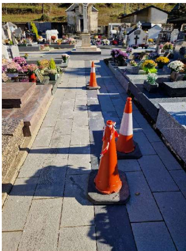
Imatge 3. Alguns del carrers del cementiri presenten graons pel mal estat del paviment base.
