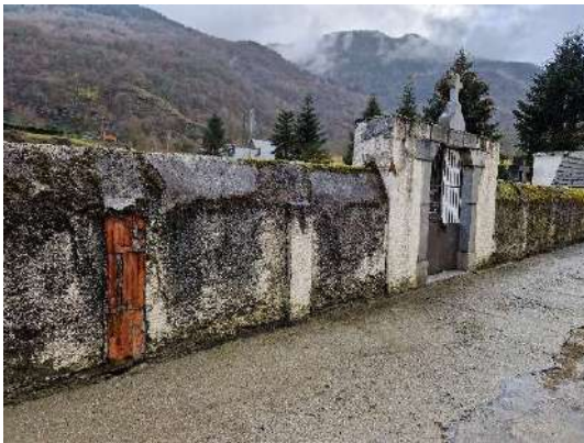
Imatge 8. Els murs perimetrals presenten alguns sectors amb esquerdes i molsa i fongs incrustats.
