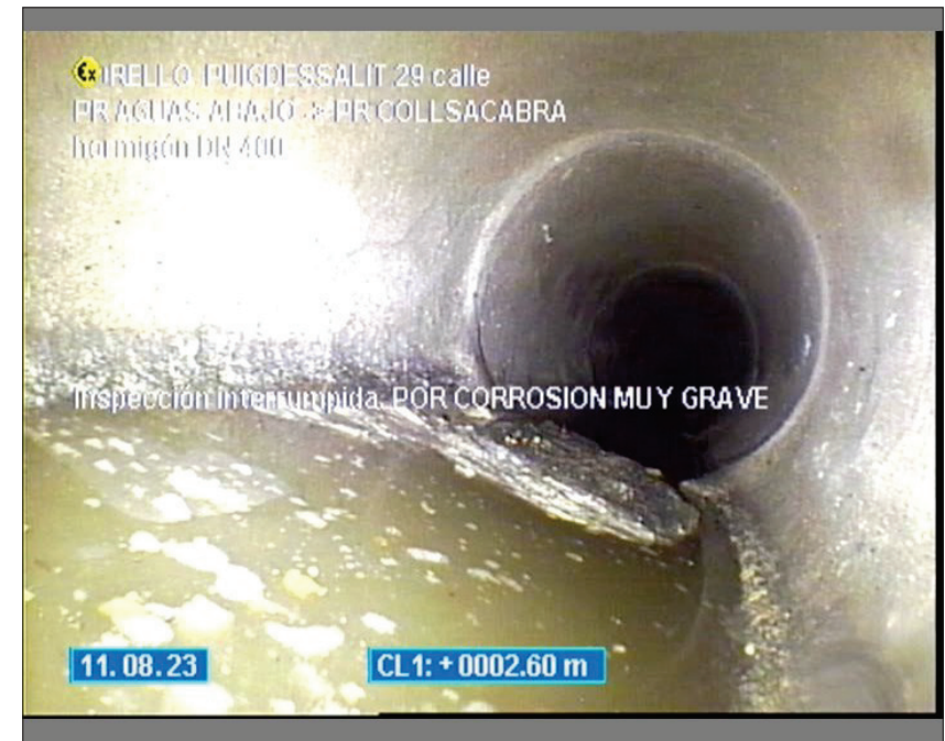
Foto: 3_3A, Medio N°: 110823_1, 00:02:16 2,6m, Inspección interrumpida / POR CORROSION MUY GRAVE
