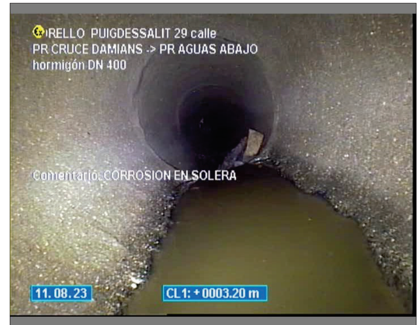
Foto: 1_2A, Medio N°: 110823_1, 00:01:23 3,2m, Comentario / CORROSION EN SOLERA
