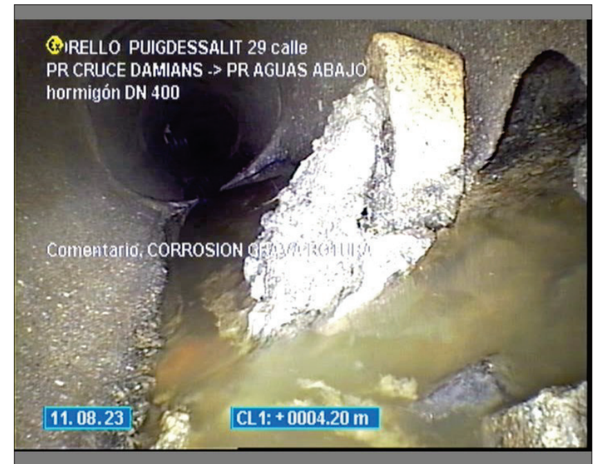
Foto: 1_3A, Medio N°: 110823_1, 00:02:30 4,2m, Comentario / CORROSION GRAVA ROTURA
