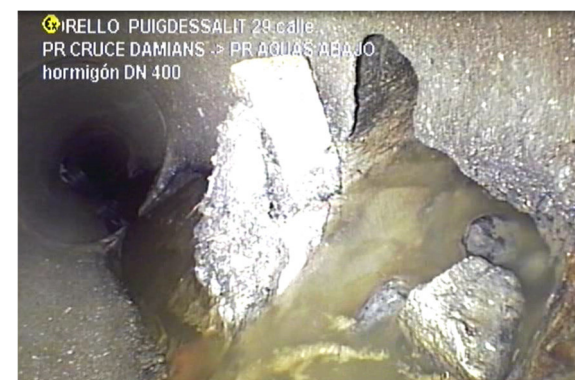
Figura 3. Imatge d'un dels danys localitzats en el col·lector mitjançant la inspecció amb videocàmera
