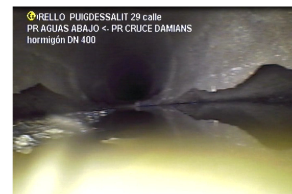
Figura 4. Imatge de l'interior del col·lector en que es pot veure que la solera del tub s'ha degradat completament.
