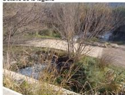
Detalle de la salida de agua
