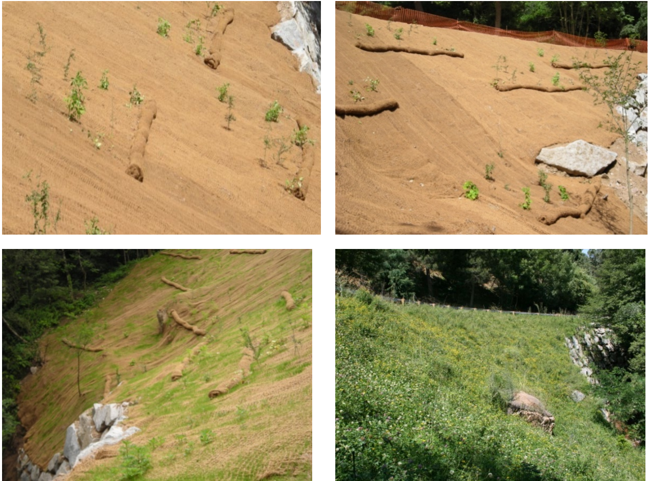
Figura 27. Roll de control d'escorrentiu
