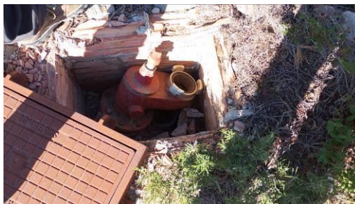
Imatge 32: Estat actual de l'hidrant soterrat.
