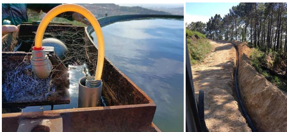
Exemple del sistema d'abastament automàtic amb boia i la instal·lació del tub d'abastiment
