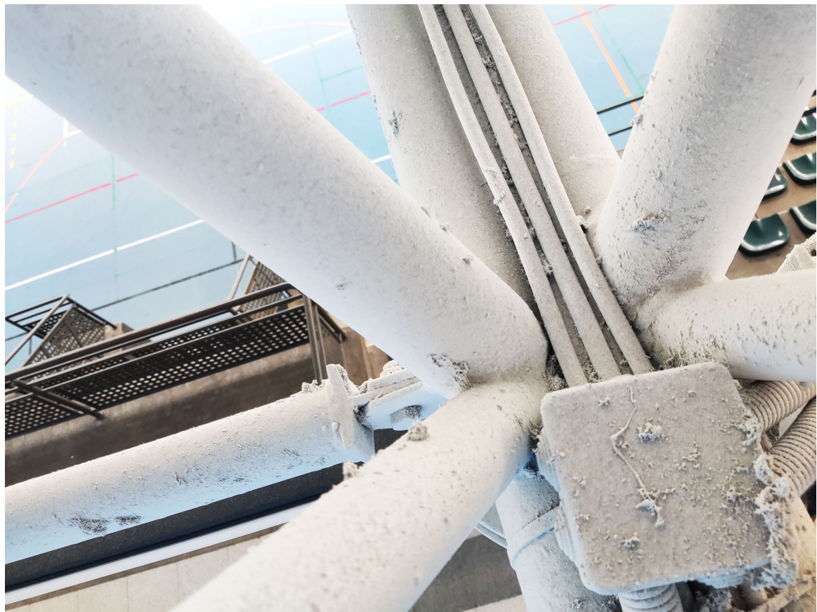
Vista superior del punt de trobada tipus de tubs amb cablejat i pintura intumescent.
