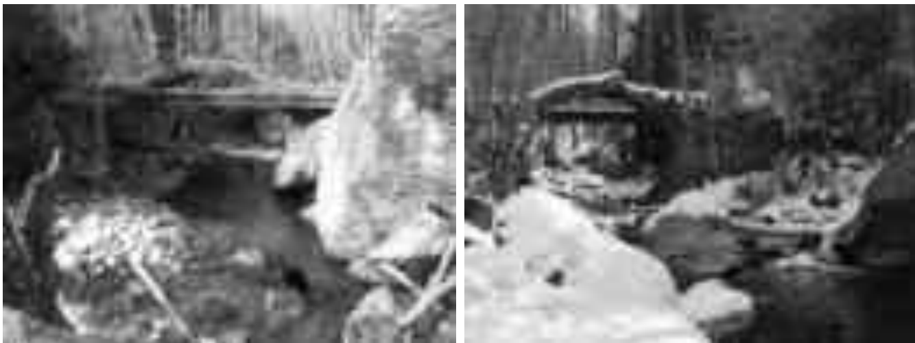
Imatges 3 i 4. Estat del pont al març de 2016 i febrer de 2018. Font: Blog de Damià Cosme.
