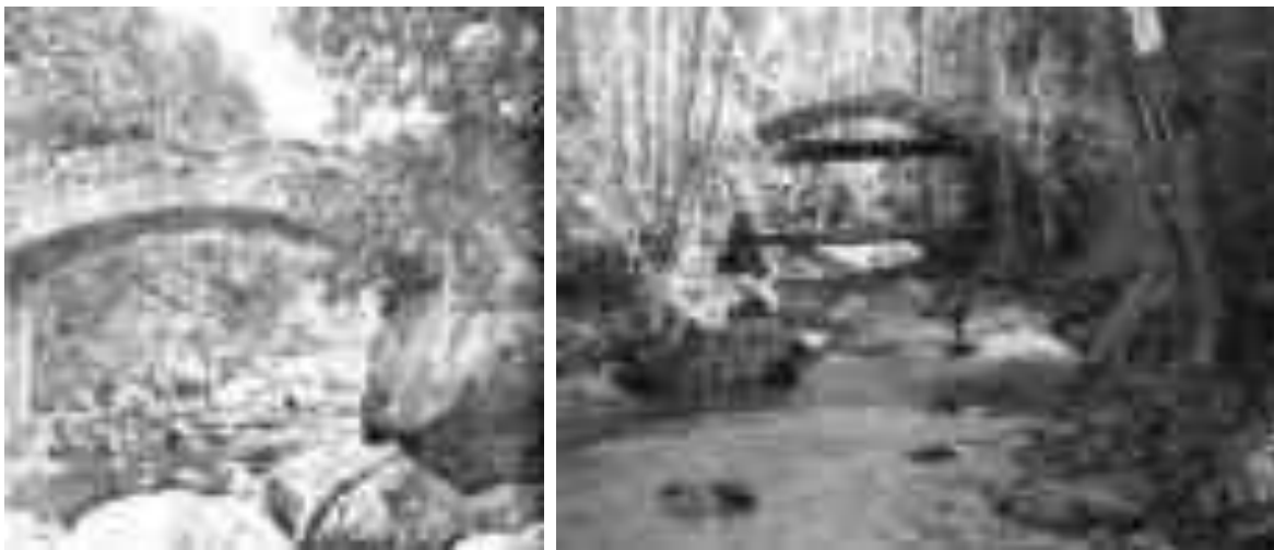
Imatges 1 i 2. Estat del pont l'any 1981 i al novembre de 2015. Font: Web Inventari de Patrimoni Arquitectònic de la Generalitat de Catalunya i Blog de Damià Cosme, respectivament.
