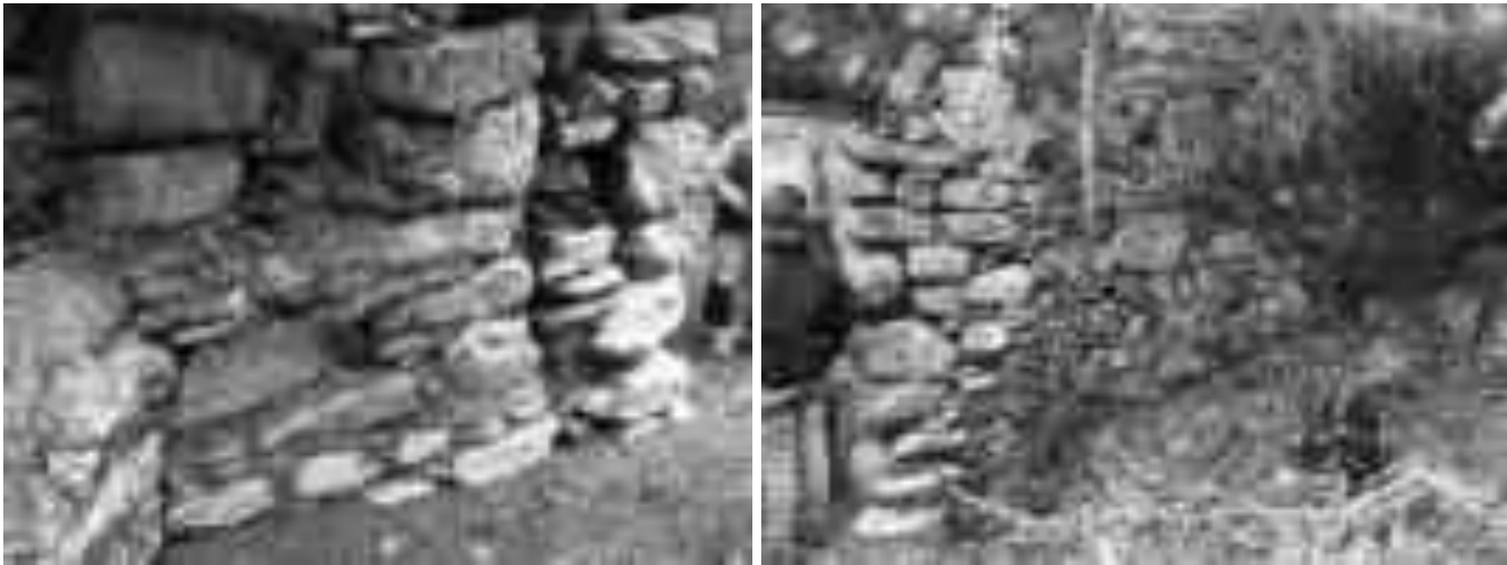
Imatges 9 i 10. Detalls de l'estrep sud, amb diversos morters de rejuntat sobreposats i erodinats. Font: Elaboració pròpia.
