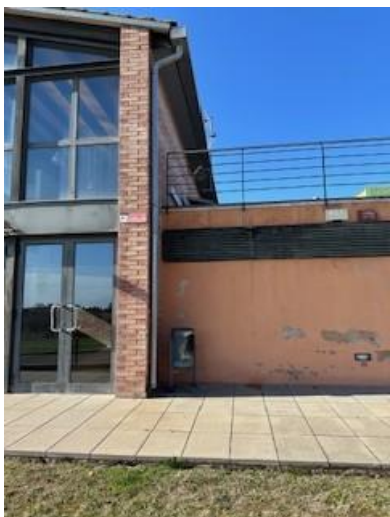
Vista exterior, punt inversor
