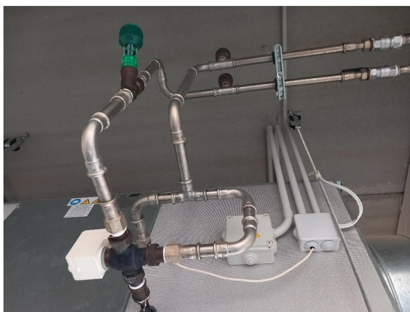
Foto 9: Detall del sistema de control i regulació dels climatitzadors
