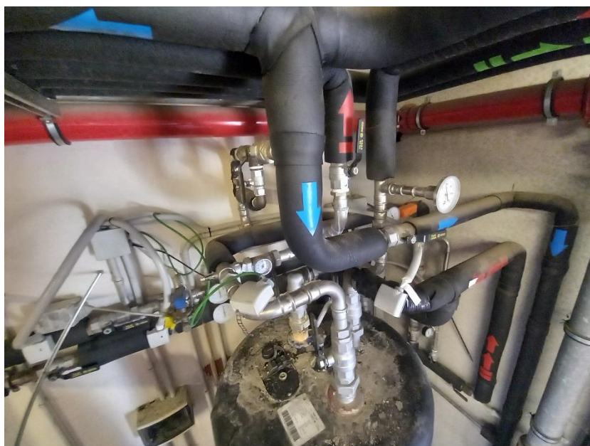
Foto 13: Sistema acumulació i distribució ACS
