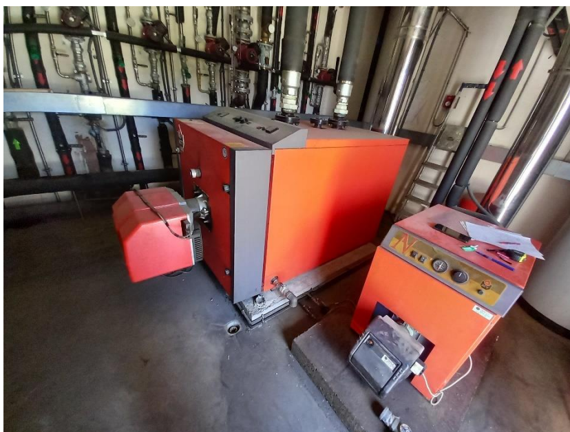
Foto 11: Sistema de Producció Calefacció i ACS
