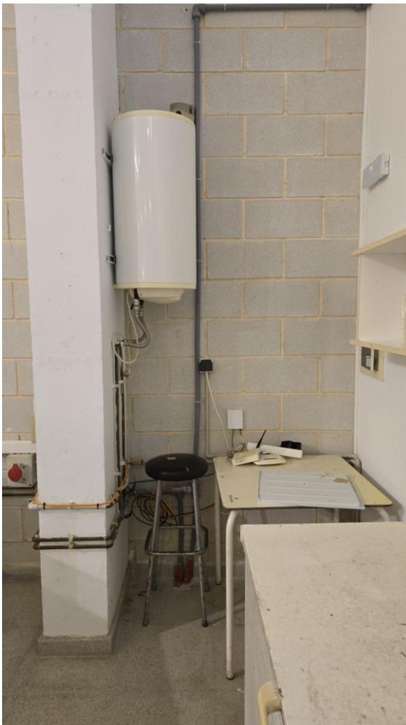
Acumulador elèctric d'ACS, situat a la zona del bar
