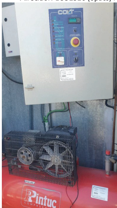
Compressor i quadre de control
