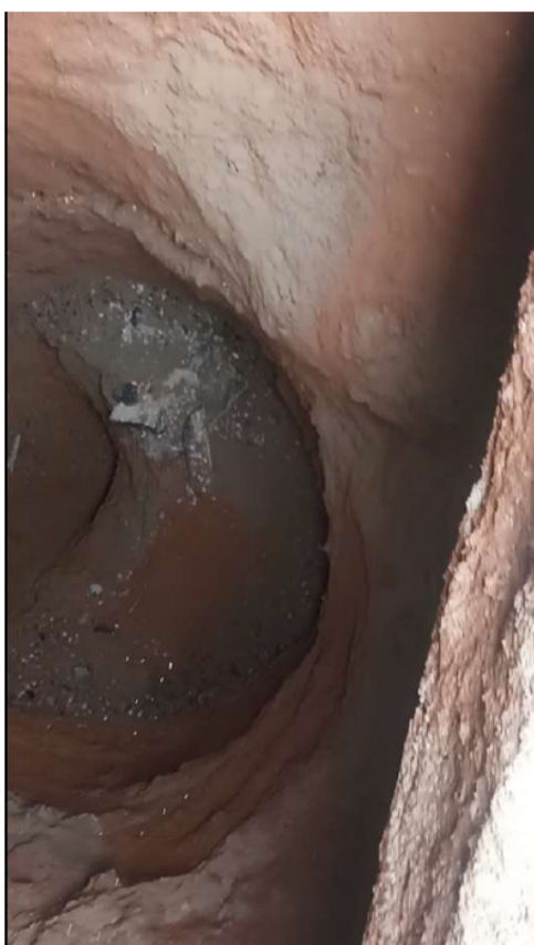
Vista de l'esvoranc des de la superfície
