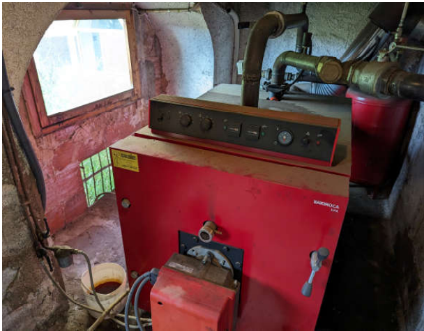
Caldera destinada a la producció de calefacció
