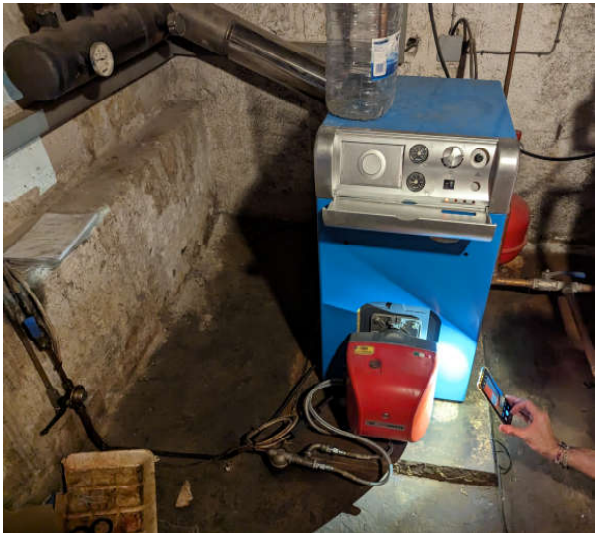
Caldera destinada a la producció d'ACS
