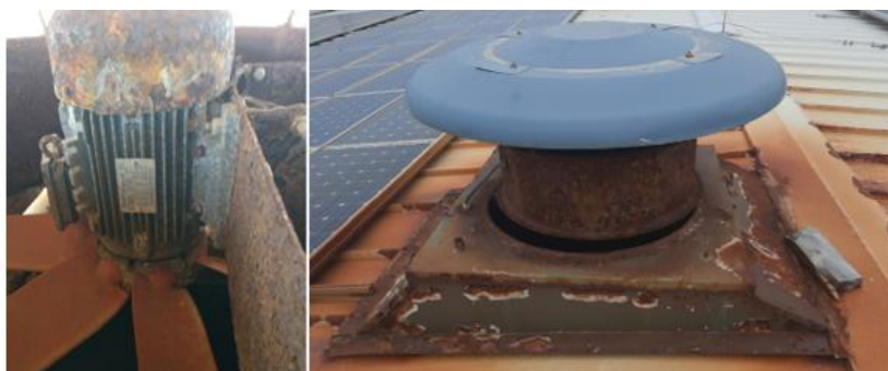
Il·lustració 2: Estat dels extractors retirats
