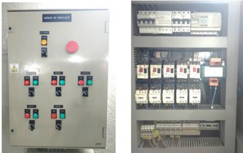
Il·lustració 5: Quadre elèctric existent
