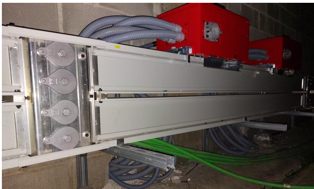
Figura 6: Pas de cablejat des del cofret del bus de barres fins al rectificador.
