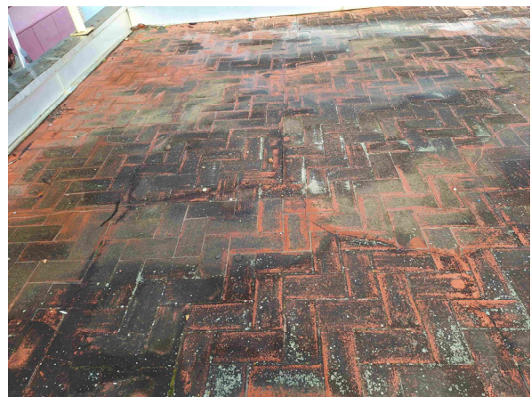
Detall cobertes. Fissures paviment rajoles ceràmiques
