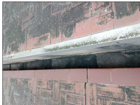
FOTO 6 - DETALL ESTAT CANALS
