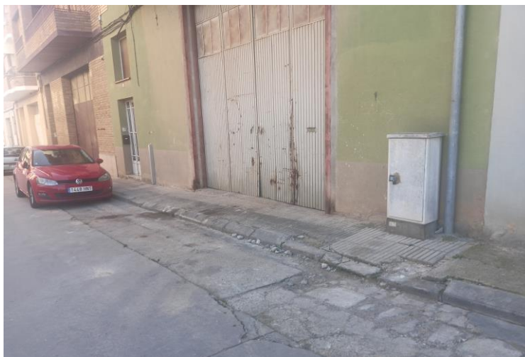
Estat actual paviment carrer i voreres
