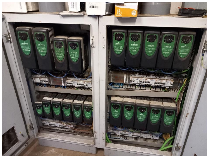
Foto 1: Armari de Variadors.
