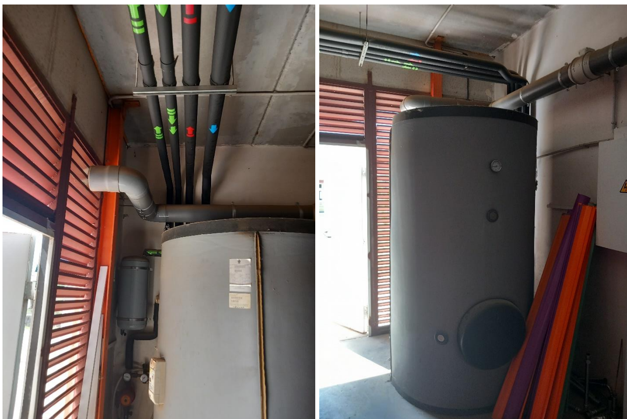
Foto 14: Sistema acumulació i producció ACS Soler tèrmic.
