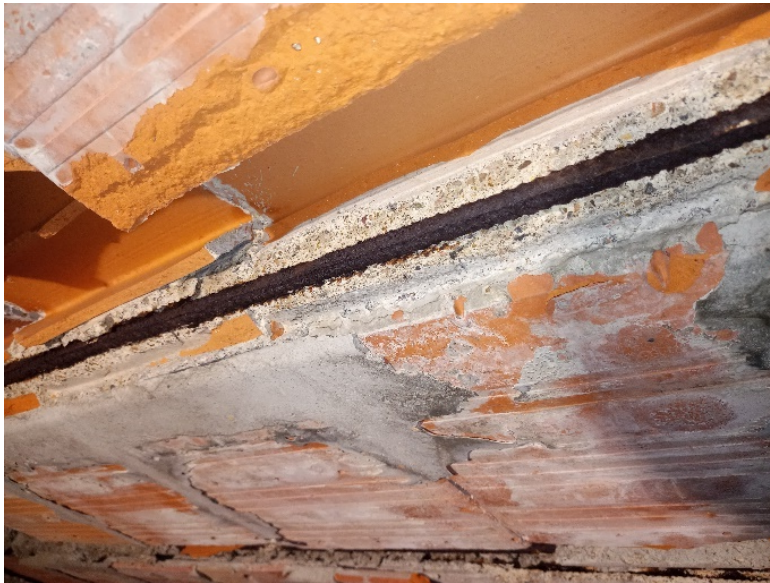
Imatge de bigueta amb rodó vist, amb pèrdua de corrua i cassetó ceràmic trencat
