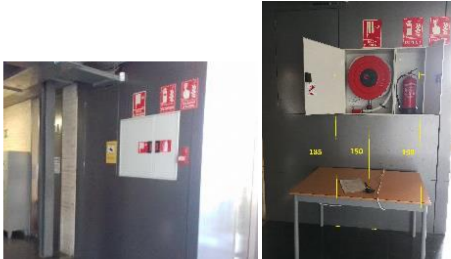
Fotografia: Imatge del conjunt de BIE i Extintor
