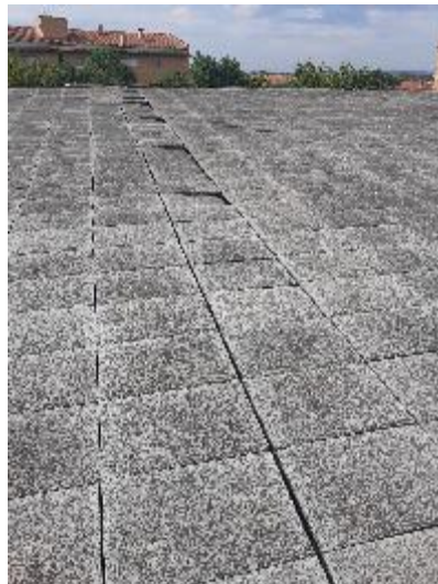
Fotografia: Junta de dilatació amb les peces desplaçades
