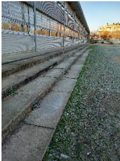
Fotografia: Detall de l'estat de les grades
