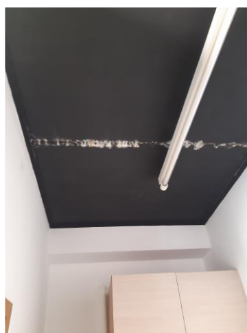
Filtració interior edifici infantil
