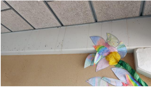
Filtració edifici primària
