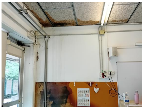
Filtració interior edifici infantil
