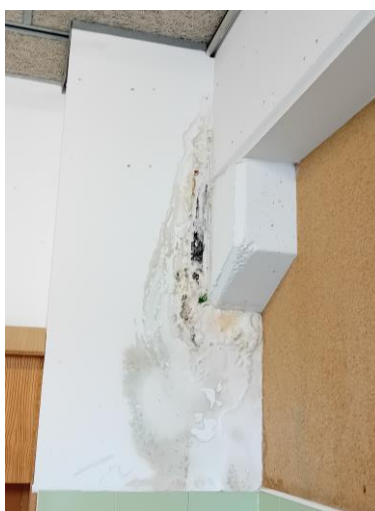
Filtració interior infantil
