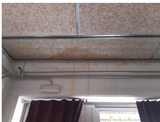
Filtració interior edifici infantil
