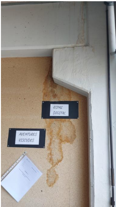
Filtració edifici primària
