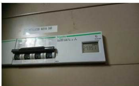
Comptador diferencial elèctric a QG
