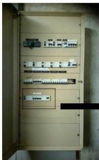
Quadre general elèctric (QG)
