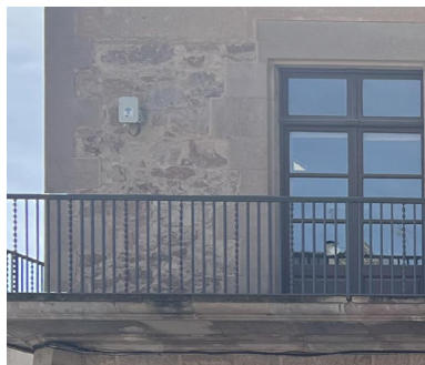
Despreniment de material.
