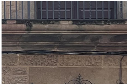
Despreniment de material.
