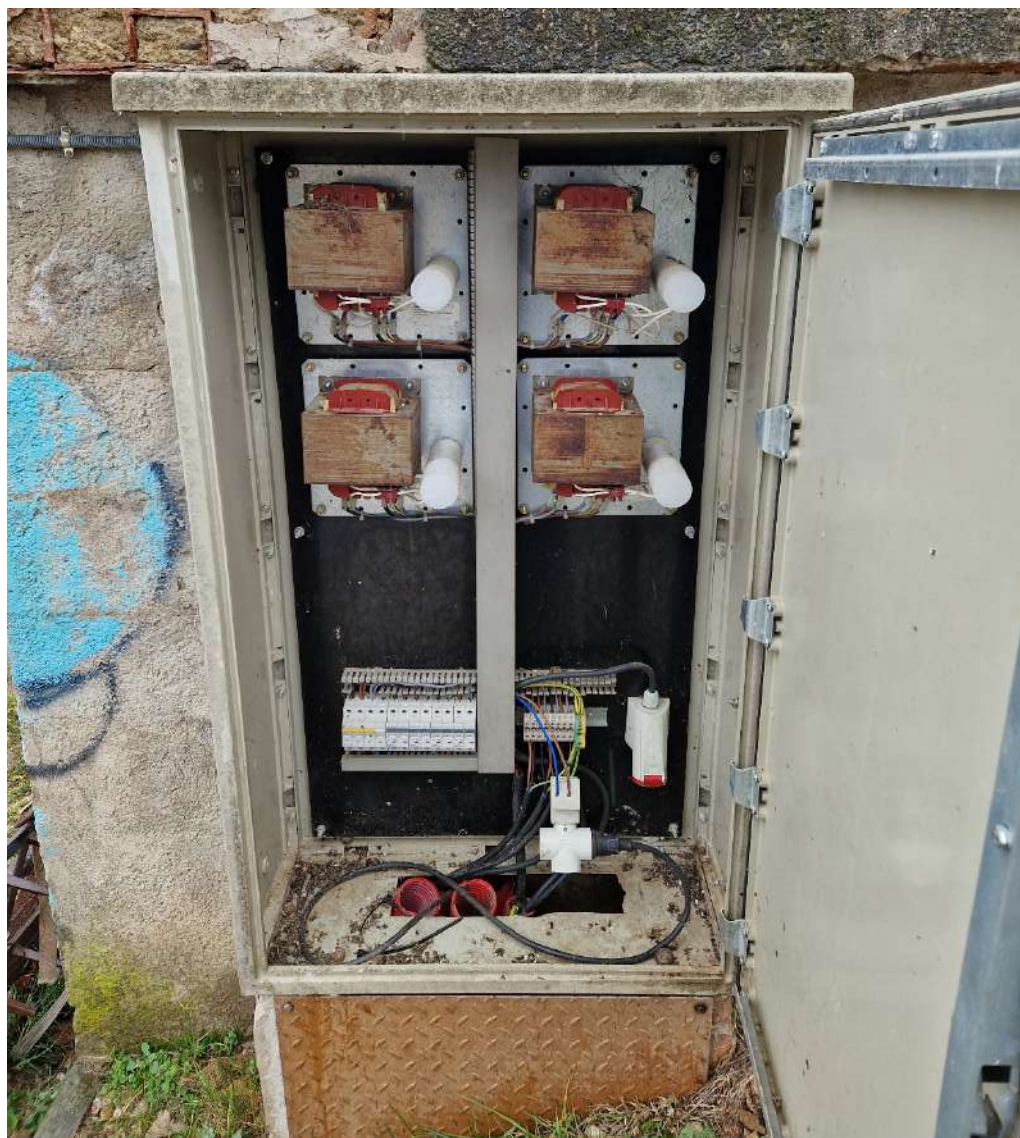
Imagen 3. Anexo al cuadro Q11 de control de iluminación sobre el campo de fútbol
