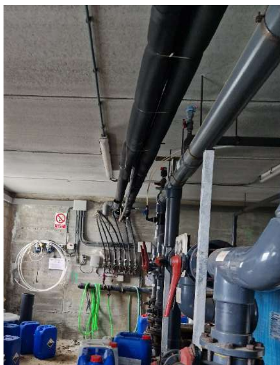
Imagen 10. Sistema de desinfección, calefacción y bombeo para la piscina.
