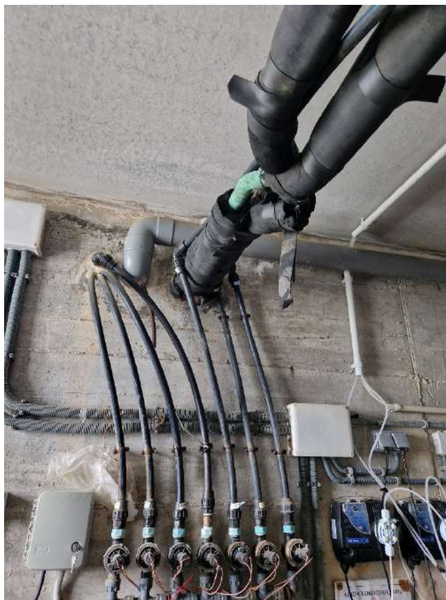
Imagen 9. Punto de entrada de agua caliente procedente del sistema de generación actual. Puntos de salida de agua a la piscina.
