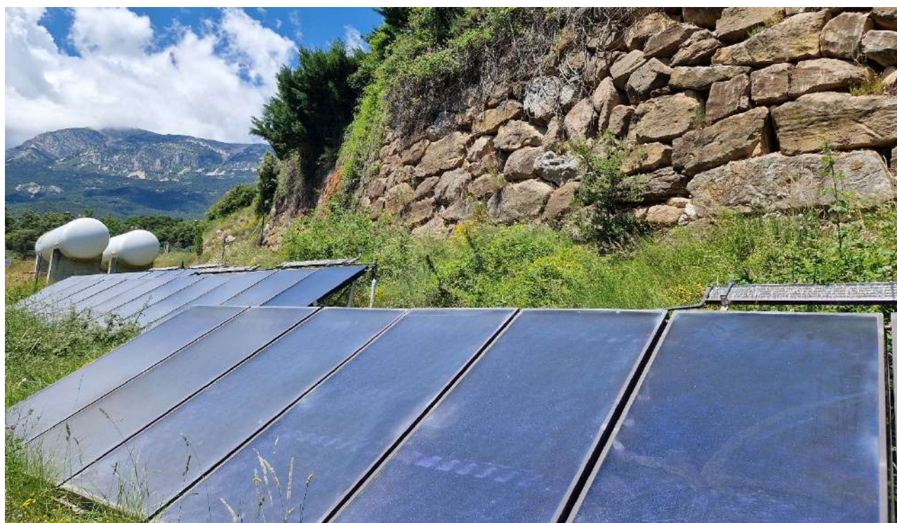
Imagen 7. Sistema de generación térmica solar existente.
