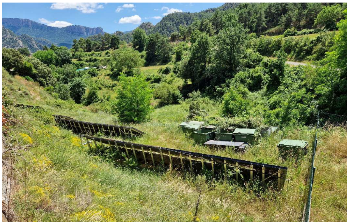
Imagen 8. Sistema de generación térmica solar existente.
